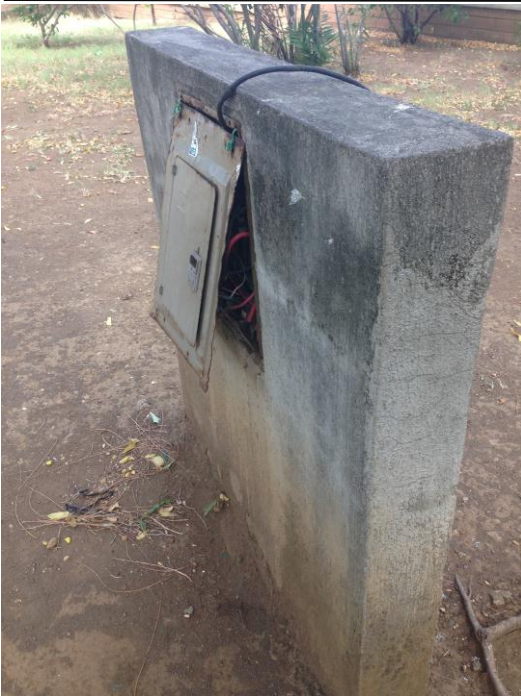
Panel eléctrico parque japonés Fotografía tomada por: Bladimir Melendez
