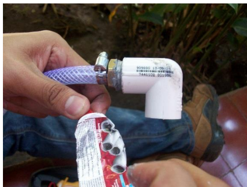
Conexión entre los biodigestores y adaptador
