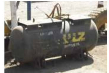
Acumulador de aire del area de las pistas de MPR.
