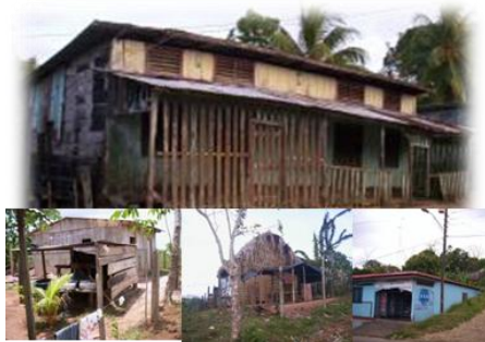
FOTO # 24: Viviendas en mal estado físico Fuente: PDUMB
