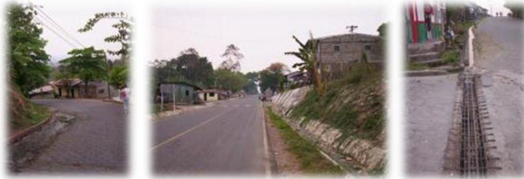
FOTO # 34: Red de Drenaje Pluvial en Buen Estado. FUENTE: Equipo PDUMB
