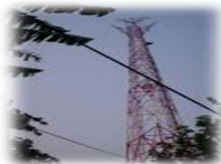
FOTO # 35: Infraestructura de telefonía CLARO FUENTE: Equipo PDUMB
