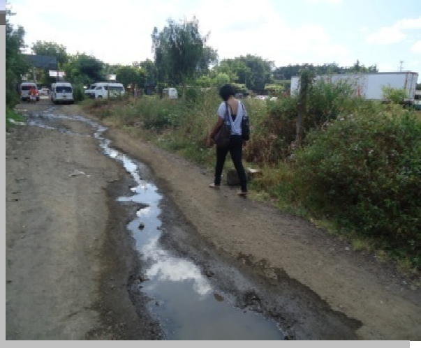
Foto 46: Aguas grises dentro en el sector. Fuente: González- Polanco 2013
