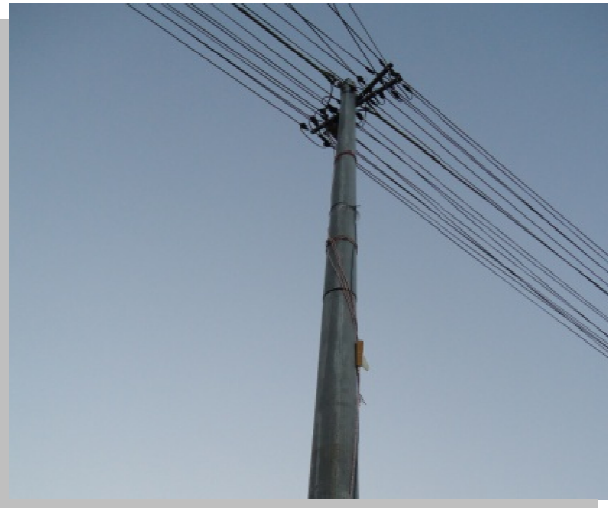
Foto 15: Postes de Cableado eléctrico Fuente: González-Polanco 2013
