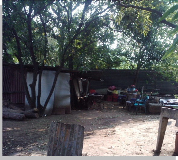
Foto 9: Vivienda en mal estado. Fuente: González- Polanco 2013
