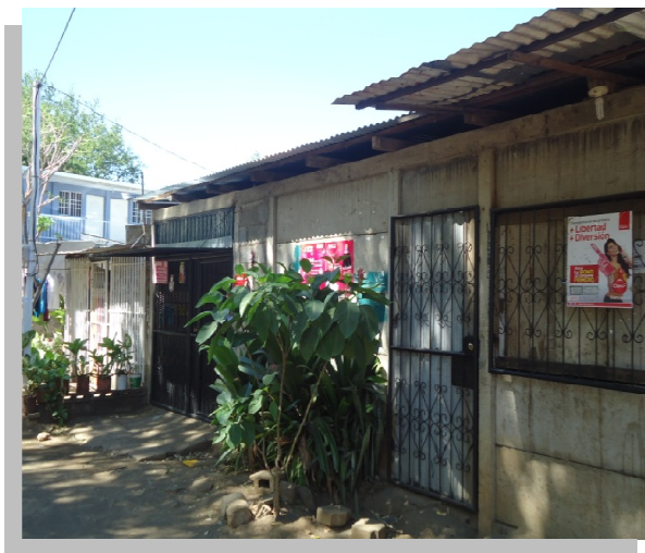
Foto 8: Vivienda con deterioro en su fachada. Fuente: González- Polanco 2013
