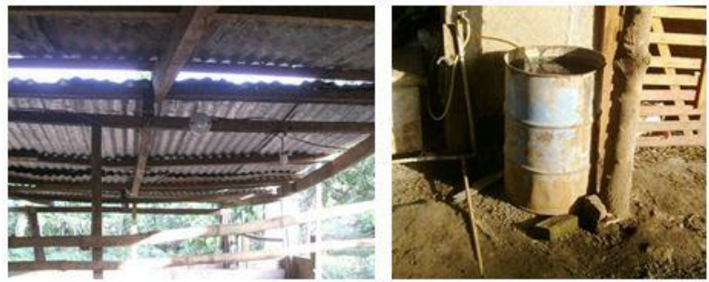
Fig. 31: Bujías eléctricas en el techo y barriles de agua para las galeras.
