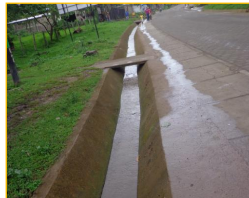
Foto Nº 18: Cunetas. “Estado Físico de las vías” Equipo de Trabajo Mendoza - Tijerino.
