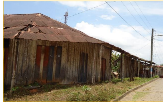
Foto N°46: Vivienda con techo y paredes en mal estado. B°, Zona 1. “Condiciones de Viviendas” Equipo de trabajo Mendoza, Tijerino
