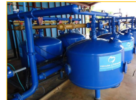
Foto N° 26: Sistema de Potabilización y Desinfección del Agua. "Agua Potable" Equipo de Trabajo Mendoza - Tijerino.
