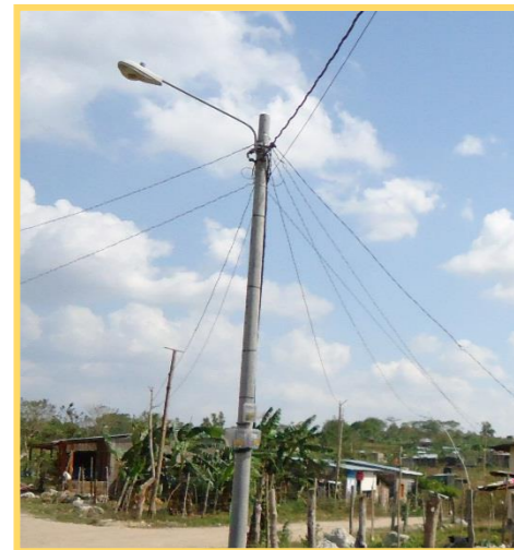
Foto N° 34: Luminarias en el Área Urbana (Barrio Miguel Merel) “Alumbrado Público” Equipo de Trabajo Mendoza - Tijerino.
