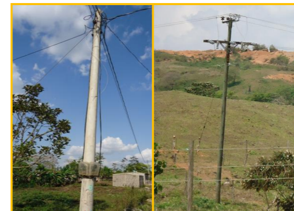
Foto Nº 33: Postes de Tendido Eléctrico de Concreto y Madera de Pino. “Telecomunicaciones”
