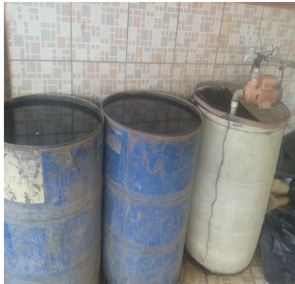
Figura 17. Abastecimiento de agua
