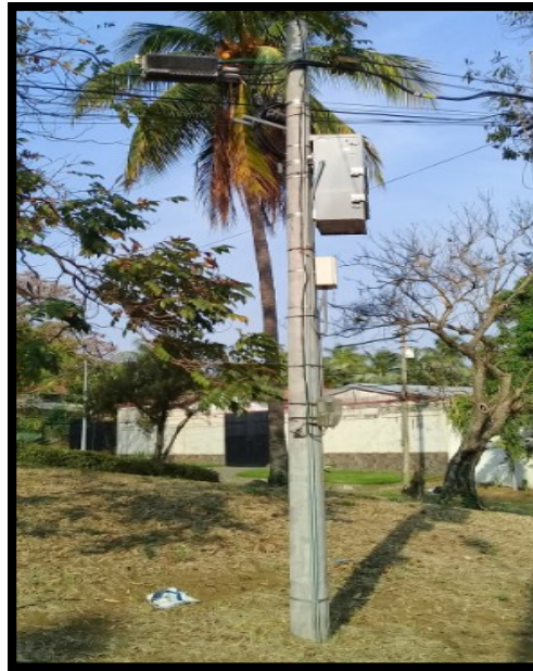
Imagen 3. Poste de concreto
