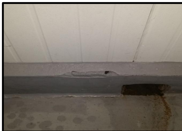
Figura 10 Área de chillas N°6 presenta grietas las uniones entre la pared.
