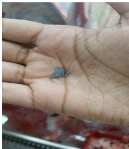
Figura 11 Broza de pintura en los rieles.
