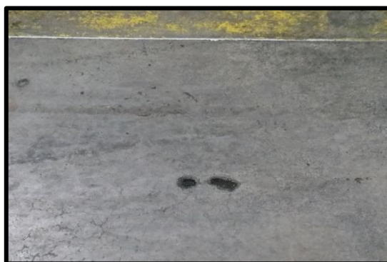
Figura 9 Piso de área de embarque con fisuras.
