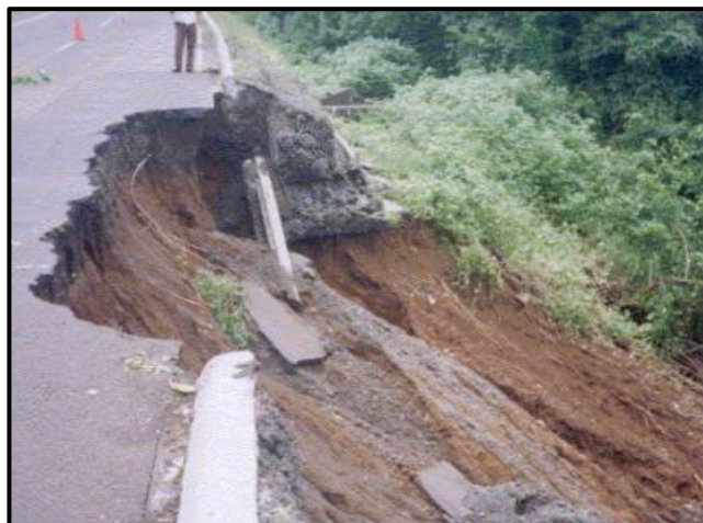
Imagen N°20. Carretera Sur km 20. Flujo de lodo ocurrido en Septiembre 2002. Fuente: Deslizamientos en Nicaragua_Ing. Tupak Obando
