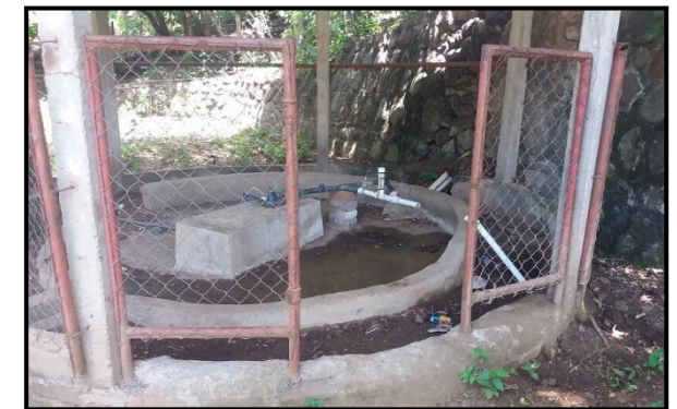
Imagen N°96. Pozo comunal ubicado en el límite de la comunidad el Guanacaste
