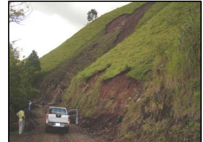
Imagen N°14. Flujo de detritos en corte de camino hacia Bigabual. Jinotega, Octubre-2005. Fuente: Deslizamientos en Nicaragua_Ing. Tupak Obando
