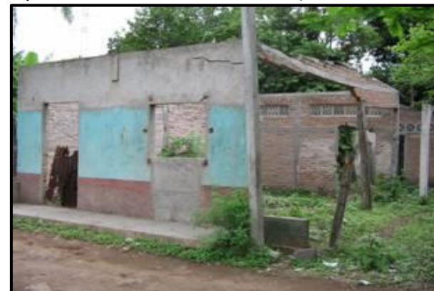
Imagen 57. Vivienda destruida por inundación del Pire. Fuente: Diagnostico municipal de Condega.
