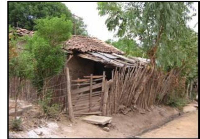
Imagen N°55. Viviendas en derecho de vía de camino a Yalí. Fuente: Diagnostico municipal de Condega.
