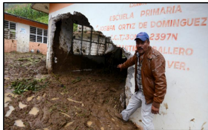
Imagen N°1. Foto de deslizamientos de tierra por tormenta
