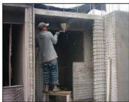
Figura No.1.23. Proceso de revoque de capa inferior losas estructurales paneles EMMEDUE.
