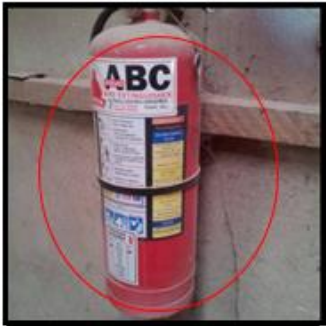
Extintor (Línea I)
