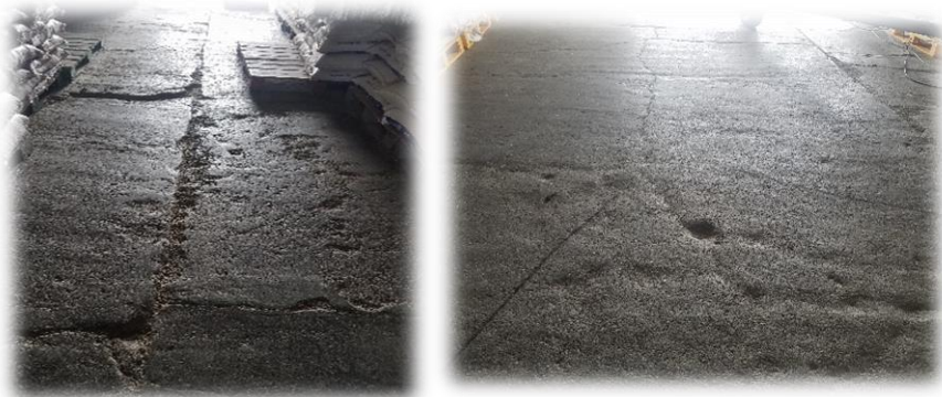
Ilustración 35 Grietas en el trillo
