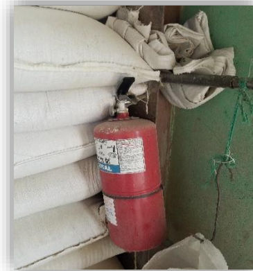
Ilustración 34 Estiba mal ubicada
