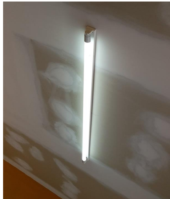
Ilustración 90 Iluminación de Lámparas LED de 15 watts, tomada en campo
