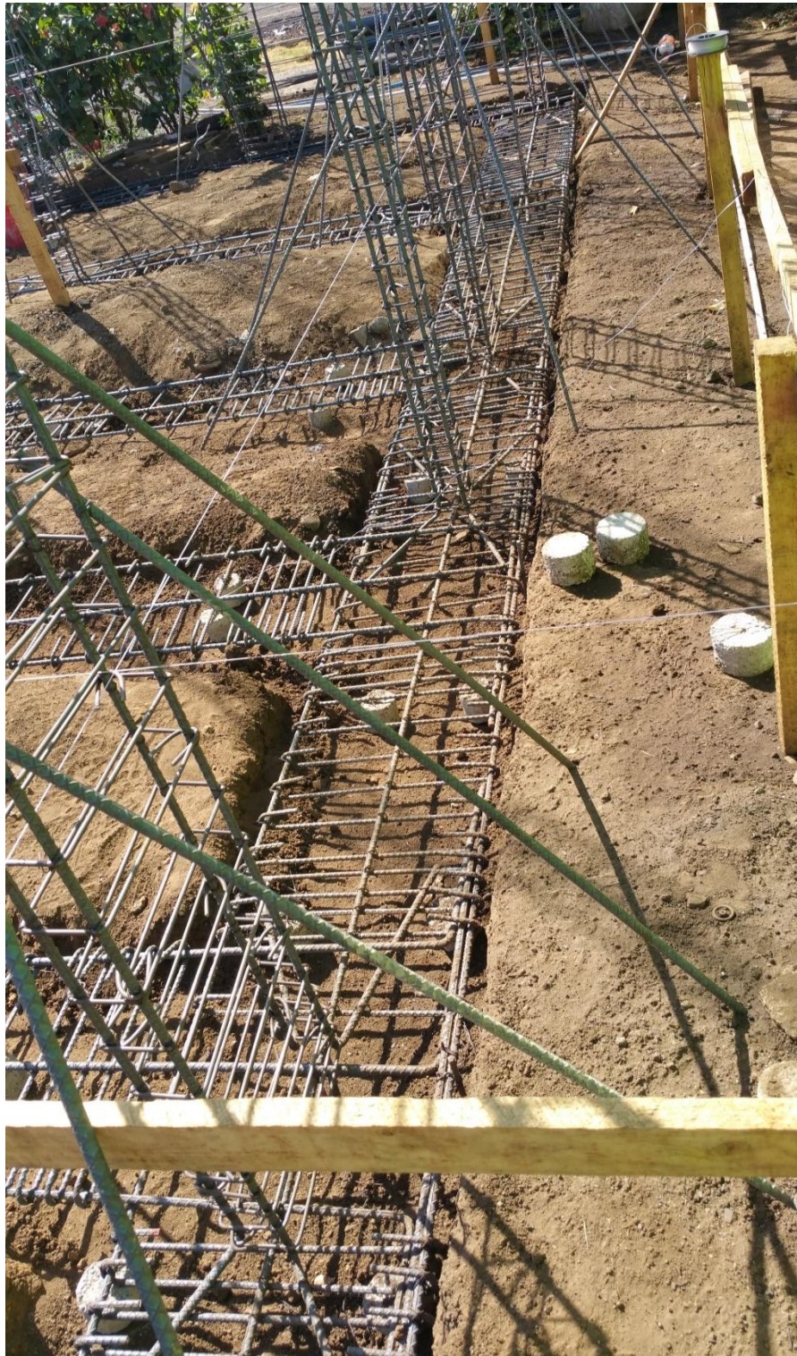
Ilustración 35 Colocación de Acero de Zapata Corrida ZC-1 con sus Respectivas Columnas, tomada en campo
