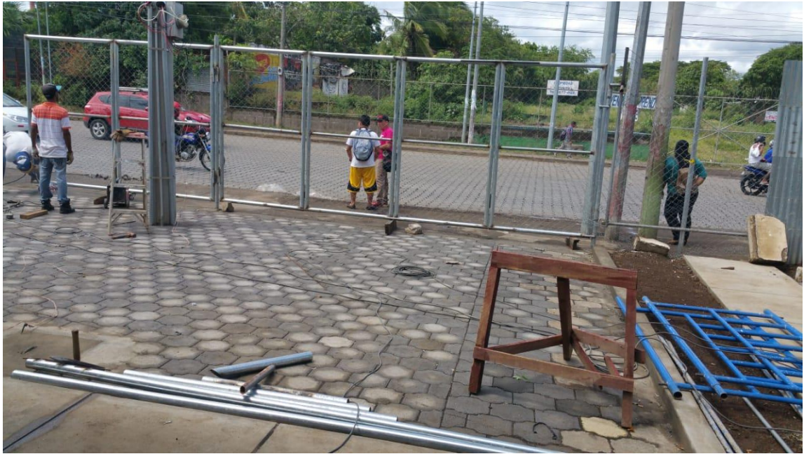
Ilustración 103 Cerca Perimetral con Tubo Galvanizado y Malla Ciclón, tomada en campo
