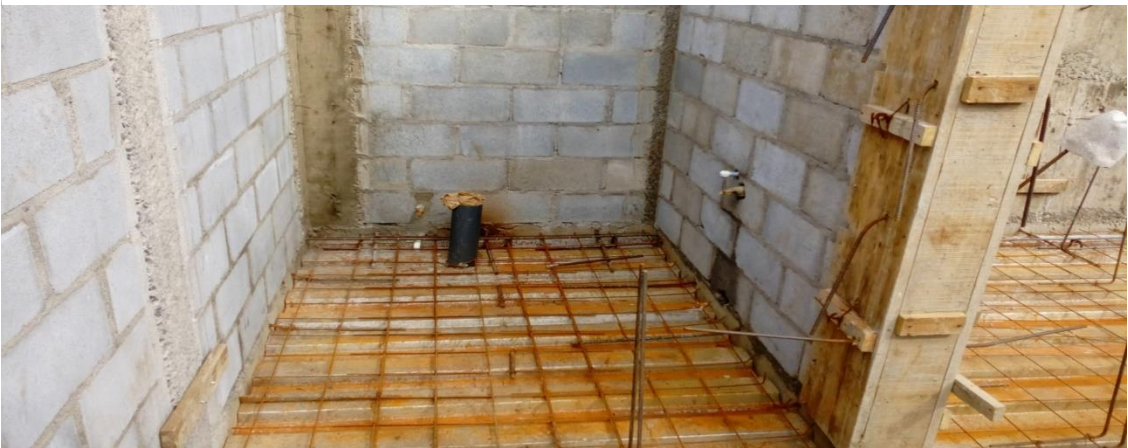
Ilustración 78 Instalaciones de Esperas Sanitarias
