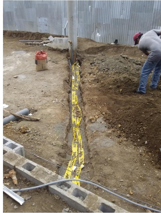
Ilustración 87 Señalización de Riesgo Eléctrico, tomada en campo
