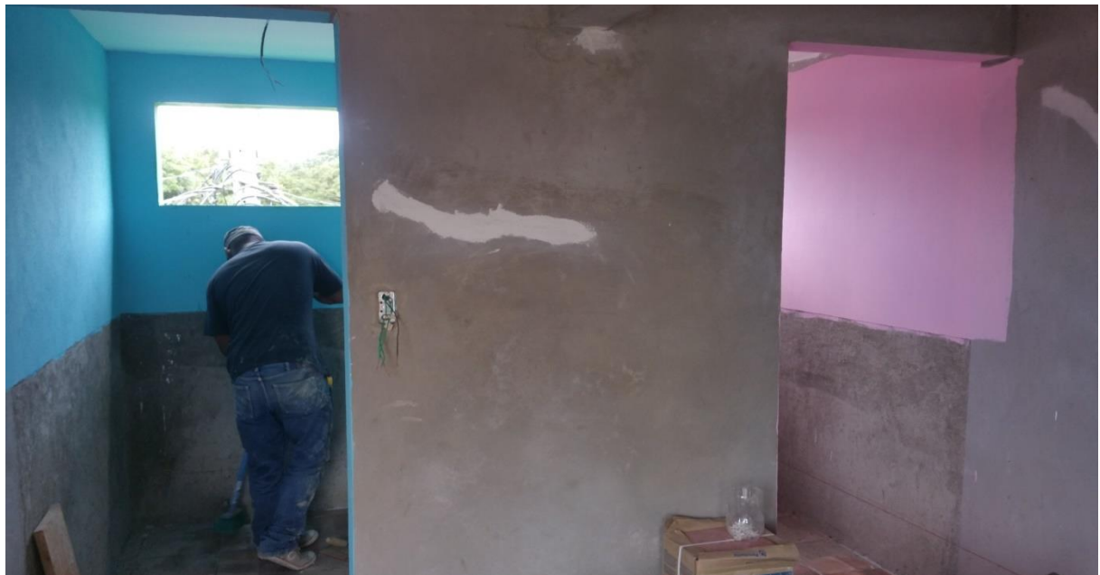
Ilustración 61 Divisiones Internas se Realizaron con COVINTEC en S.S. del 2do Piso, tomada en campo
