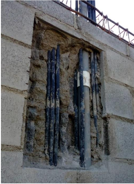
Ilustración 83 Canalización de Espera para Centro de Carga, tomada en campo
