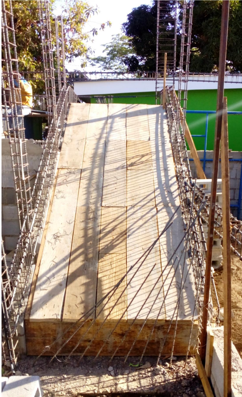
Ilustración 42 Formaleta de la Base de la Escalera Primer Tramo, tomada en campo
