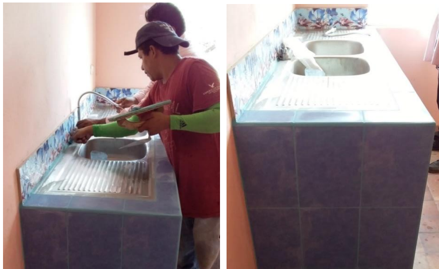
Ilustración 79 Instalación de Pana Pantry, tomada en campo
