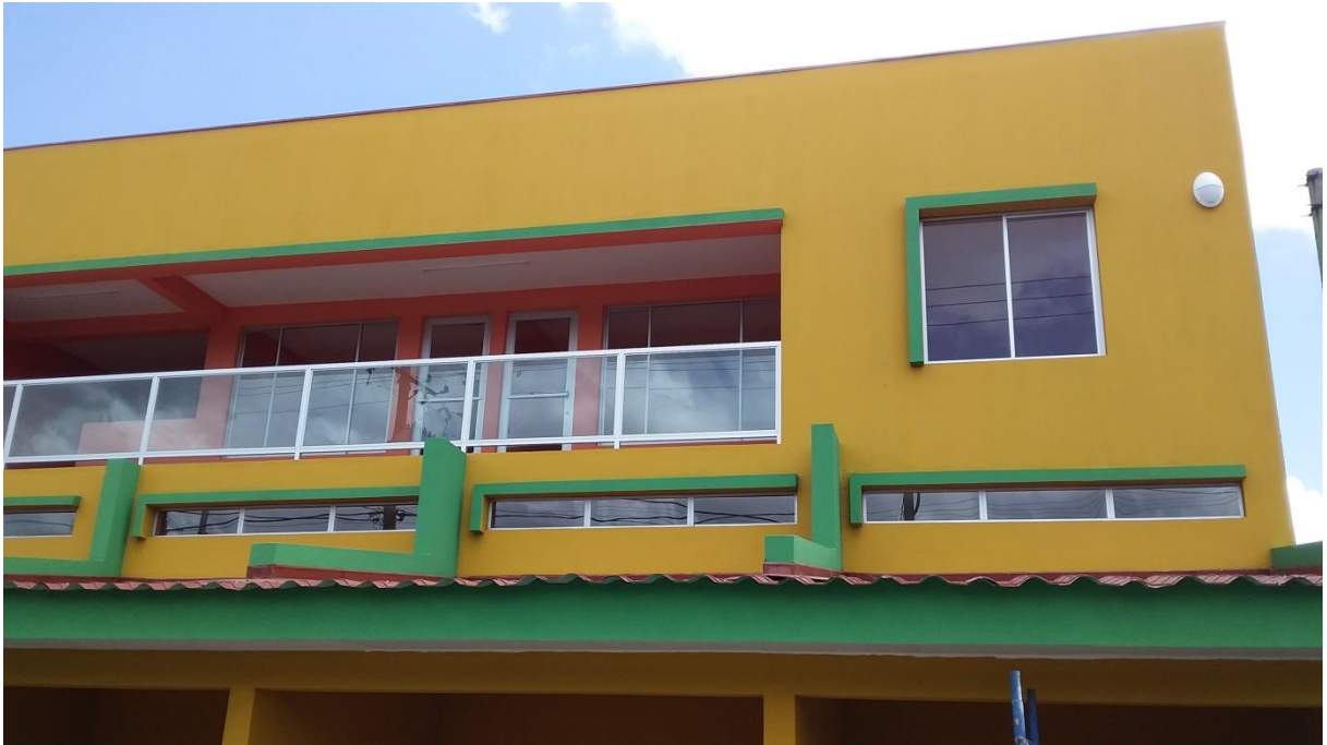
Ilustración 72 Ventanas de Vidrio Fijo, Ventanas Corredizas en Oficinas y Sala de Reunión, Puertas y Barandal, Todo de Aluminio y Vidrio Color Natural, tomada en campo
