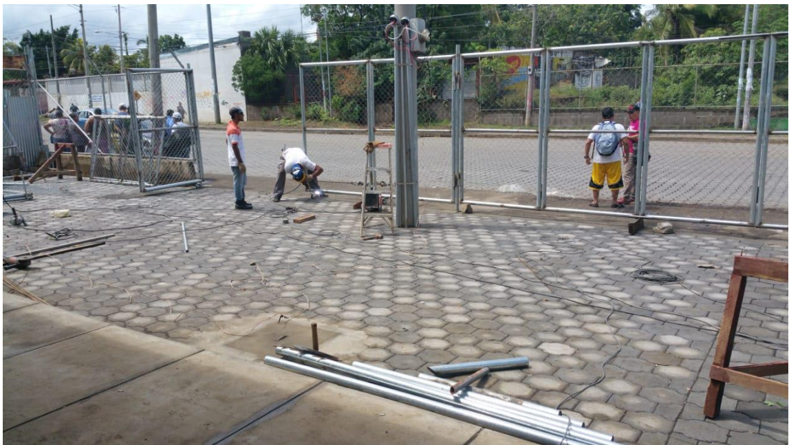
Ilustración 104 Portones y Cerca Perimetral con Tubo Galvanizado y Malla Ciclón, tomada en campo
