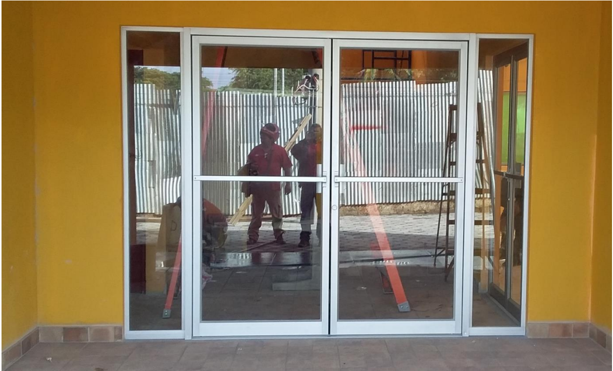
Ilustración 70 Puerta de Acceso Principal de Aluminio y Vidrio Color Natural, Este Tipo de Puerta se Instaló en el Auditorio, Oficinas y Sala de Reuniones, tomada en campo
