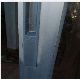
Ilustración 17. Vertical de puerta corrediza manchado
