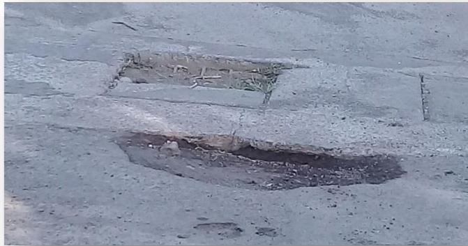
Ilustración 23. Foto de calle en mal estado.
