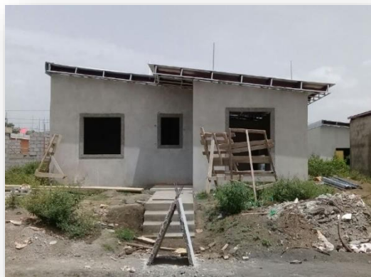
Ilustración 20. Vivienda con gradas extras por altura de terraza.
