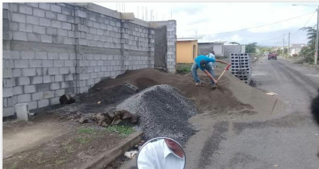
Ilustración 25. Foto obstrucción de drenaje pluvial.
