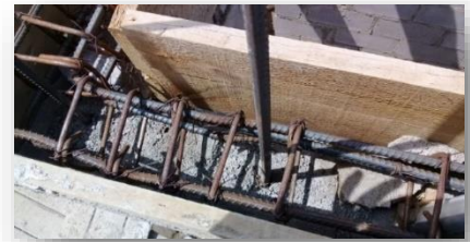
Ilustración 13. Acero de refuerzo deformado
