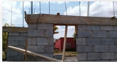
Ilustración 12. Formaleta mal elaborada y mal colocada.
