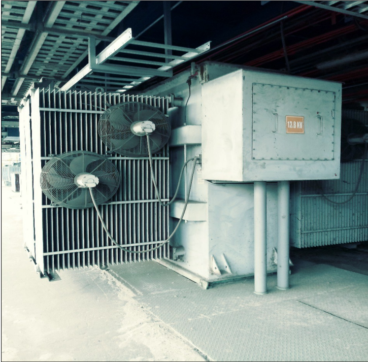
Imagen 33-Transformadores/Fuente: Álvaro Bosques
