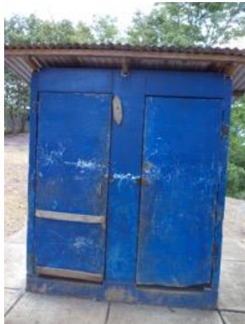
Figura 14: Vista de las letrinas en mal estado del Centro Escolar San Pablo de Kubaly, Fuente: elaboración propia, municipio de Waslala, Región Autónoma Costa Caribe Norte.
