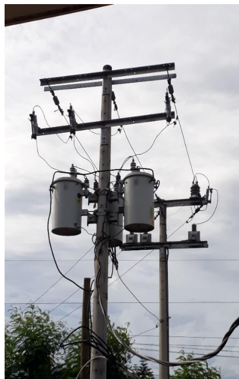
Ilustración 5. Banco de transformadores existentes.
