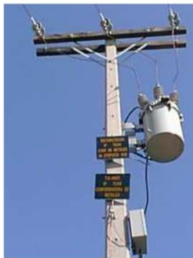
Figura 7. Dispositivo de protección Reanexador.
