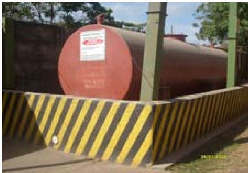
Fig. No. 7.21 Tanque de combustible
