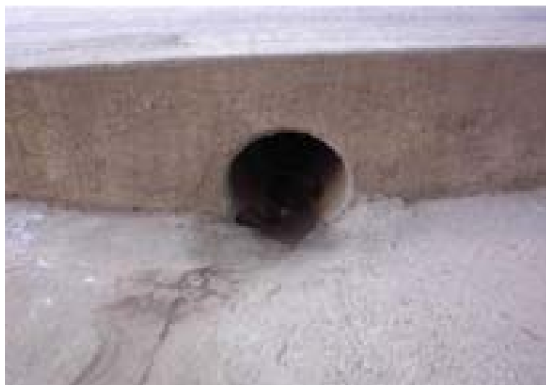
Fig. No. 7.9 Drenaje sin rejillas
