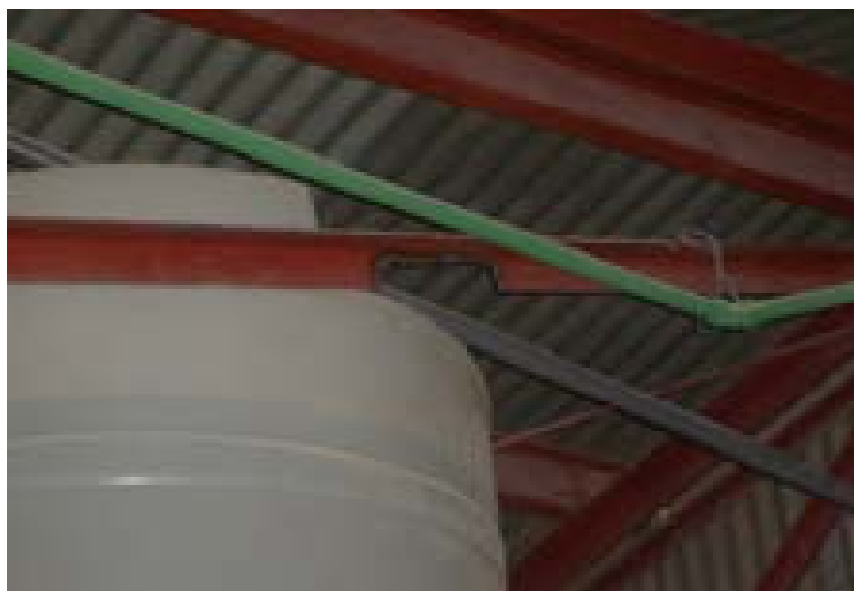
Fig. No. 7.30 Tubería de agua de color verde
