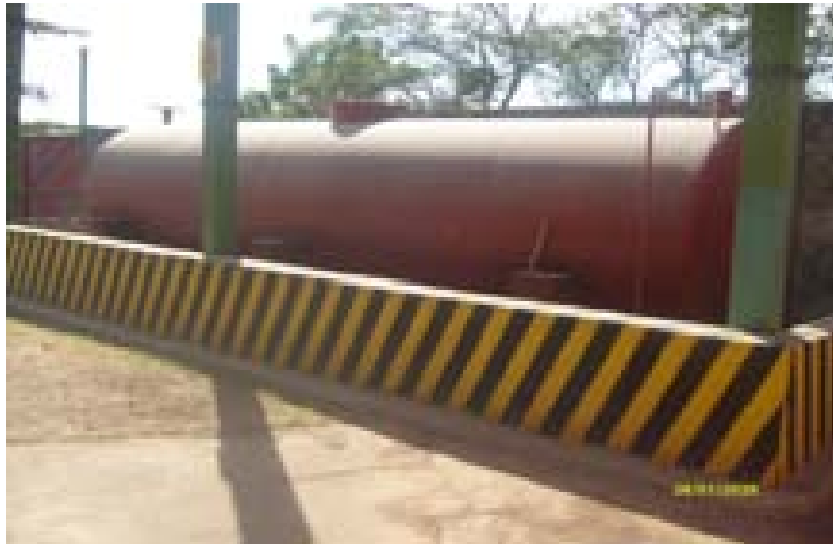
Fig. No. 7.20 Tanque de combustible
