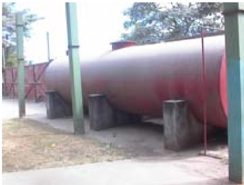
Fig. No. 7.4 Tanque de Combustible
