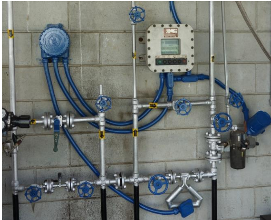
Ilustración 11: Equipos y tuberías fuera de servicio
