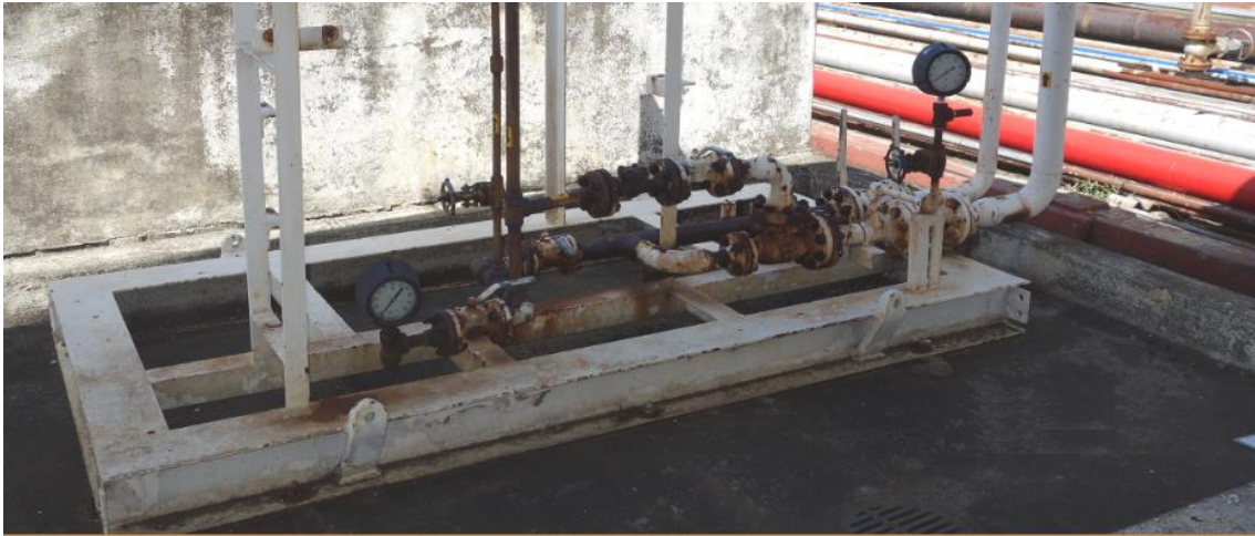
Ilustración 9: Diques, drenajes y corrosión del sistema
