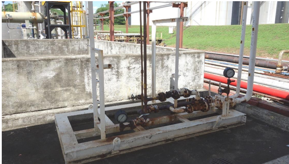
Ilustración 19: Eductor del sistema actual
