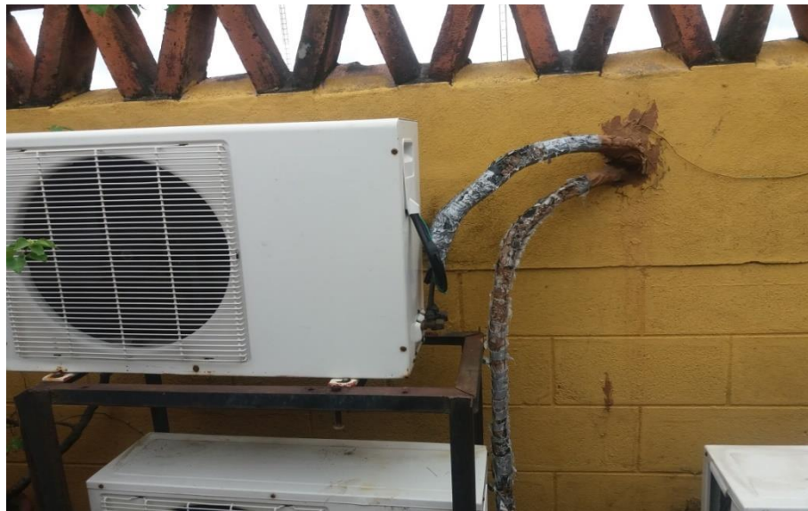
Ilustracion14 Muestra del deterioro y falta de mantenimiento de los equipos de climatizacion en el hotel
