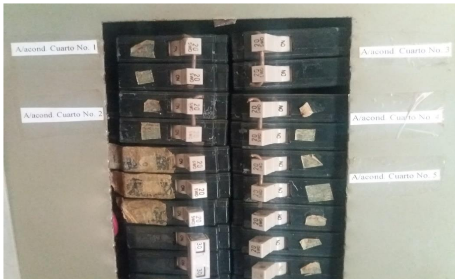
Ilustracion20 caja de backest de los aire acondicionados del salón de evento.
