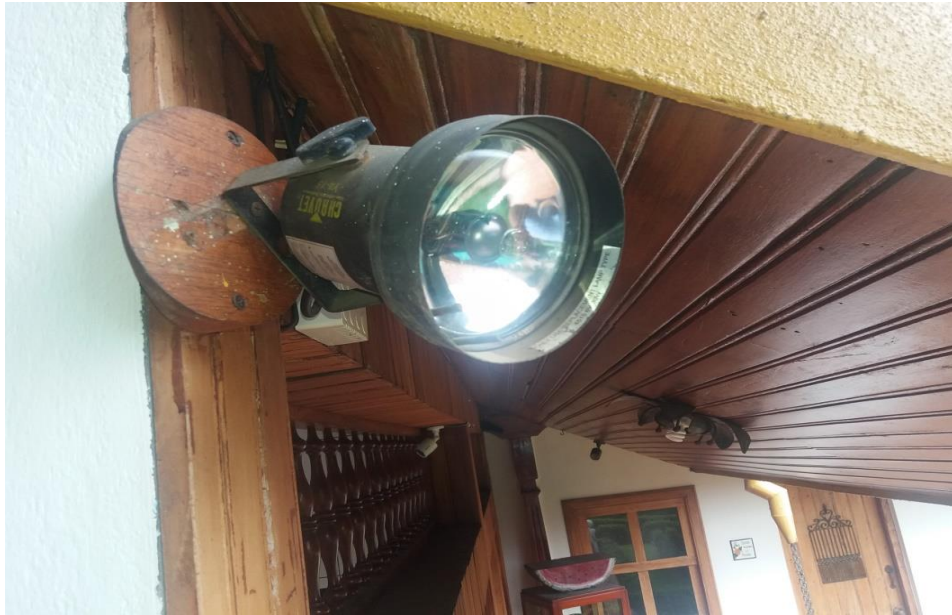
Ilustracion12 Luminarias de distintos voltajes utilizados en los pasillos del hotel
