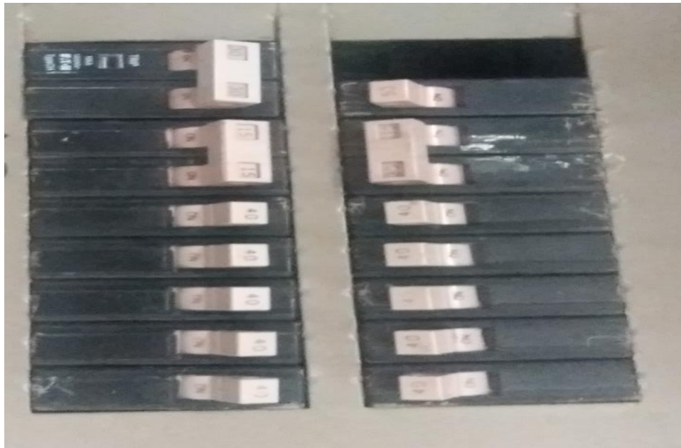
Ilustracion17 Caja de brackest de las luminarias instaladas los cuartos del hotel
