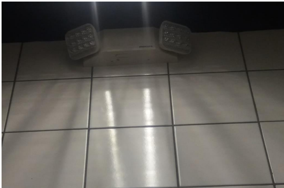
Ilustracion8 Luminarias utilizadas en los pasillos y baños del salon de eventos
