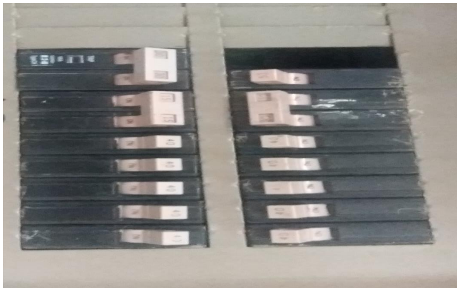
Ilustracion18 Caja de brackest para los aires acondicionado de cuartos 1, 2, 3, 4, 5 del hotel
