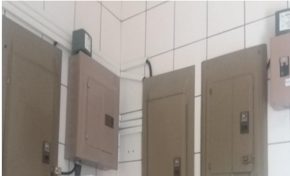
Ilustracion15 Panel de control de energía eléctrica del hotel
