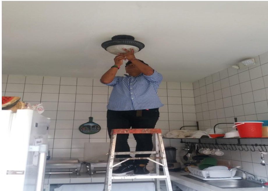
Ilustracion6 luminarias y equipos electricos utilizados en la cocina del hotel.
