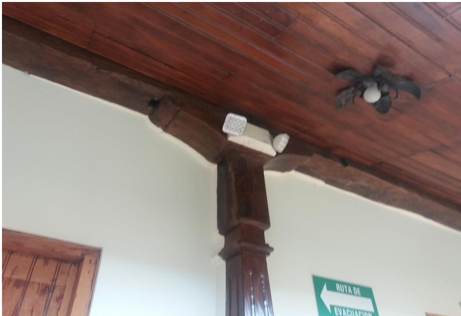
Ilustracion4 tipos luminarias instaladas en los pasillos del hotel
