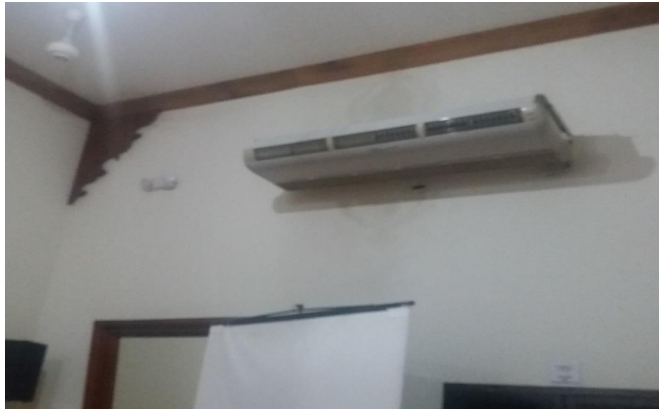
Ilustracion9 Aire Acondicionado utilizado en el salon salon de eventos
