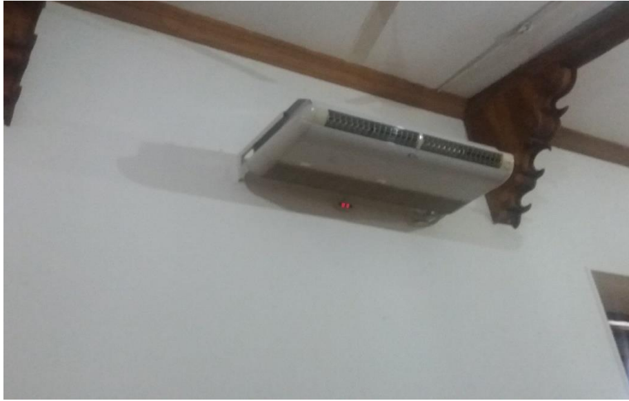
Ilustracion13 Aire Acondicionado utilizados en los cuartos del hotel
