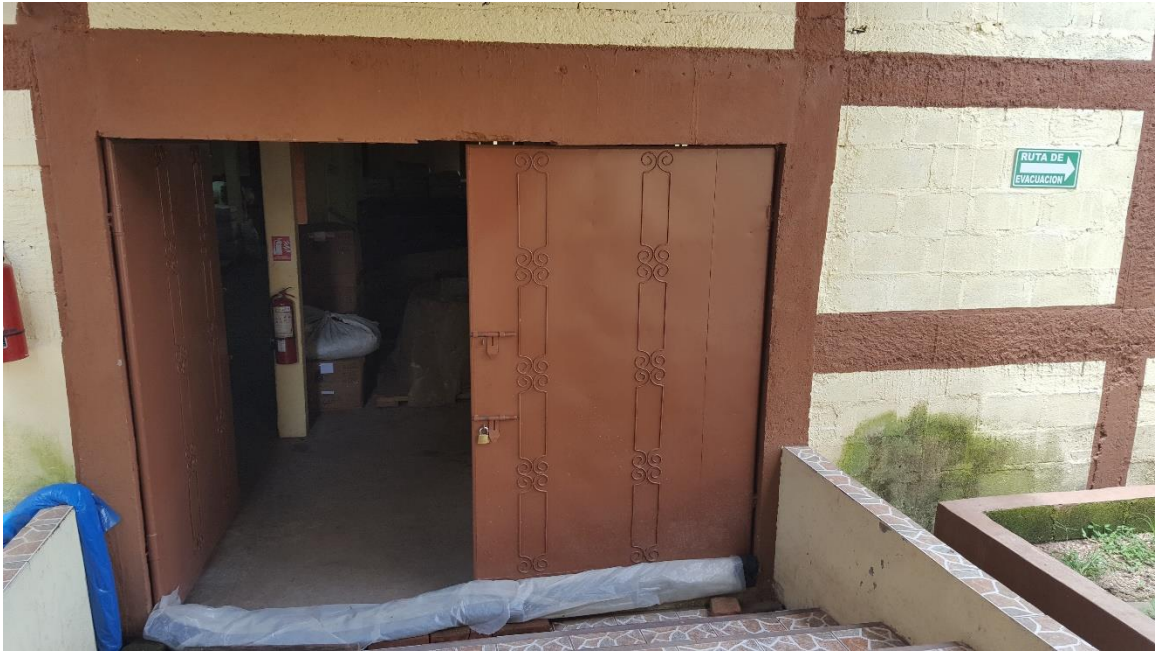
Ilustración 44 Riesgo Caída de persona a distinto nivel
