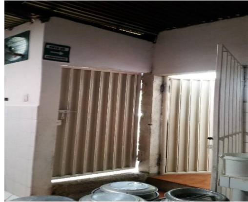
Figura 50. Salidas de emergencia del área de producción.
