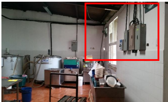
Figura 54. Caja de registro sin rotular
