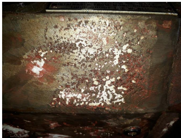
Figura 57: Imperfecciones superficiales en el metal base.
