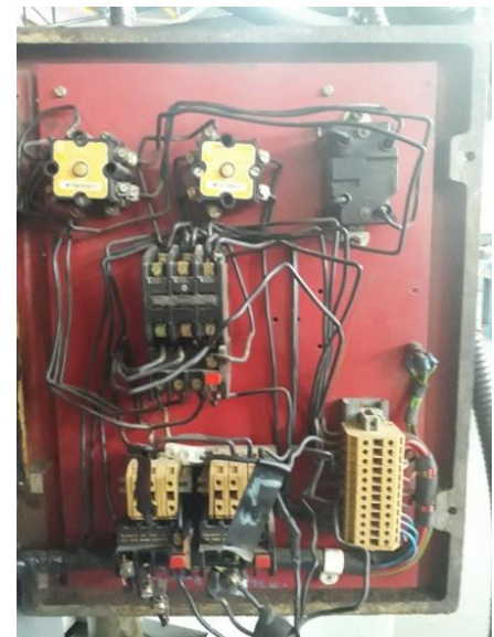
Figura 50: Panel eléctrico de la fresadora.
