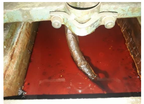
Figura 46: Deposito de refrigerante sucio.
