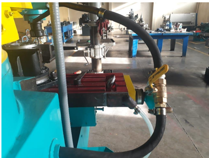
Figura 81: Válvula de medio giro instalada en la manguera de refrigerante.
