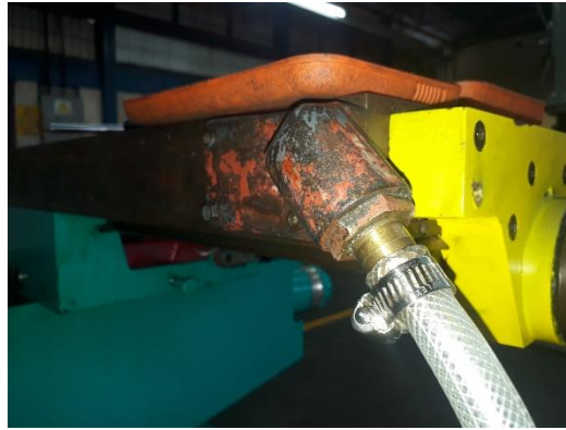
Figura 76: Ubicación del desagüe en la mesa de trabajo con su nueva manguera y brida de sujeción.
