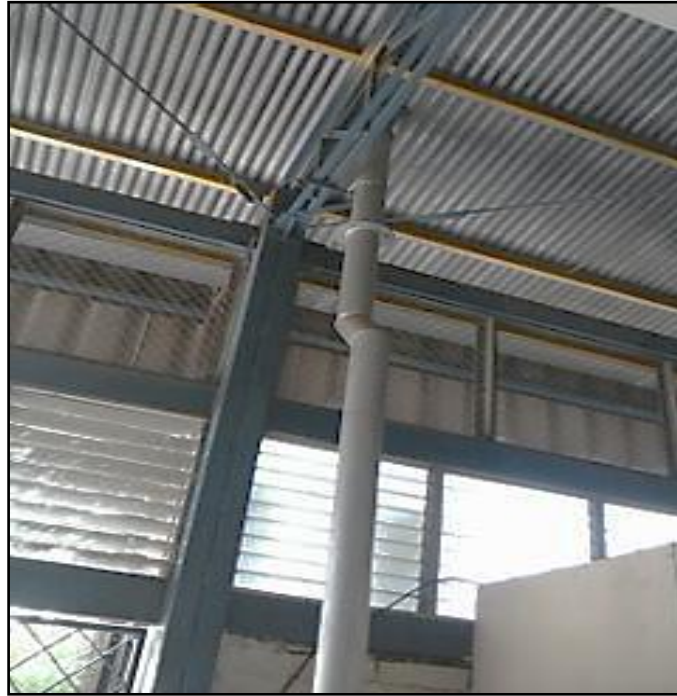
Fig. 7.13 Tubería para la evacuación de los gases
