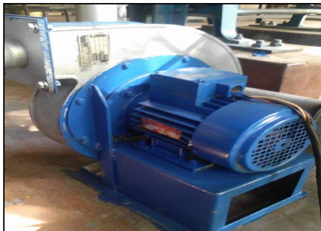
Fig.7.2. Motor eléctrico, ventilador
