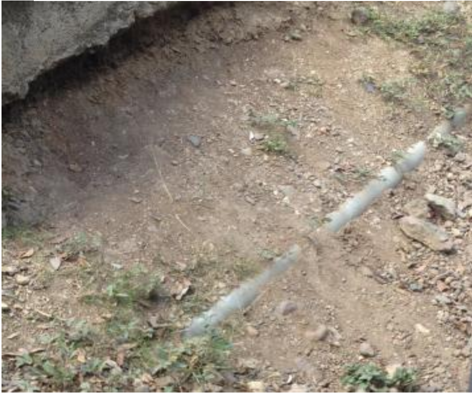
Ilustración 21: Tubería superficial en ciertos sectores del casco urbano
