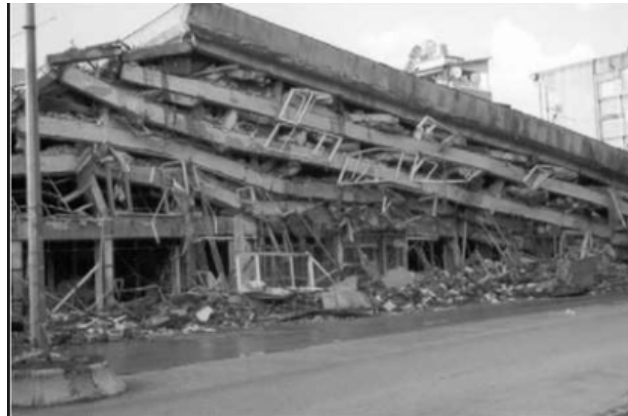
Figura 3.2 Falla de piso débil. Tomado de Google Imágenes
