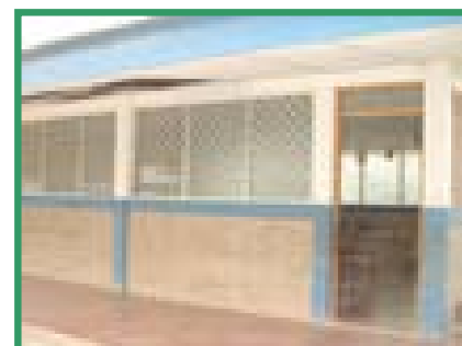
Vista exterior del agrupamiento 1, se observa el deterioro del cielo raso.
