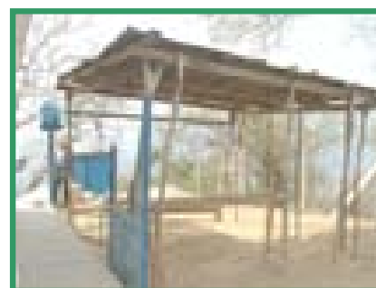
Vista de agrupamiento 2, se observa el mal estado y las falta de condiciones de este.
