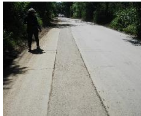
Foto 20: la carretera no brinda seguridad a los peatones estación 3+300-4+700.
