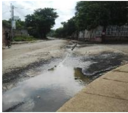
Foto 17: Est. 8+040 Empalme Los Vanegas, salida del Colegio Pablo A. Cuadra sin simbología.
