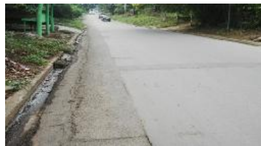
Foto 13: No hay línea discontinua en el tramo est. 5+350.
