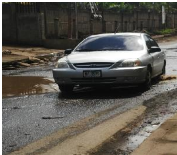
Foto 67. Vado en mal estado, subtramo Ent.a Sabana Grande –Ent. a Esquipulas.
