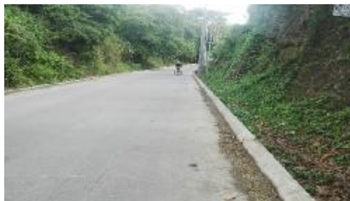
Foto 12: Estacion 0+950 no hay línea continua en proximidades de curvas.
