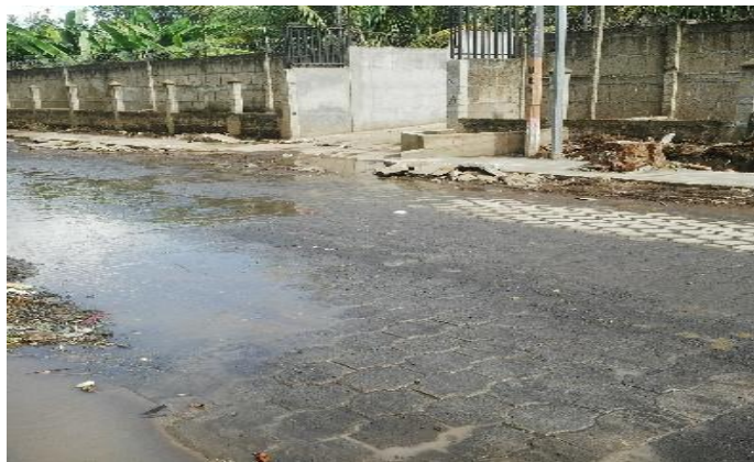
Imagen 65. Adoquinado en mal estado sector Colegio Pedro Antonio Cuadra.
