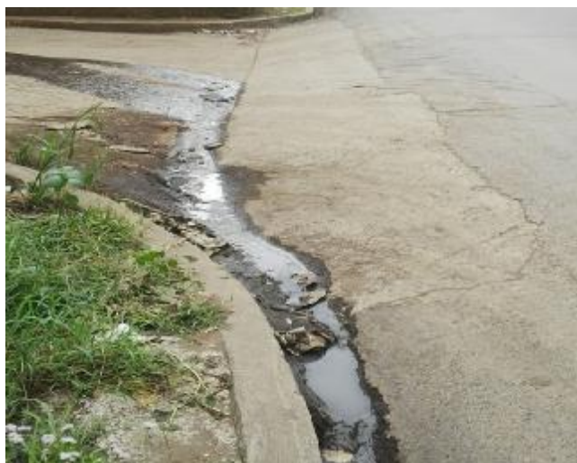
Foto 68. Cuneta sucia y en mal estado, sector Platinic.
