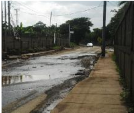
Foto 16: Cruce peatonal insuficiente Colegio Pablo A. Cuadra.
