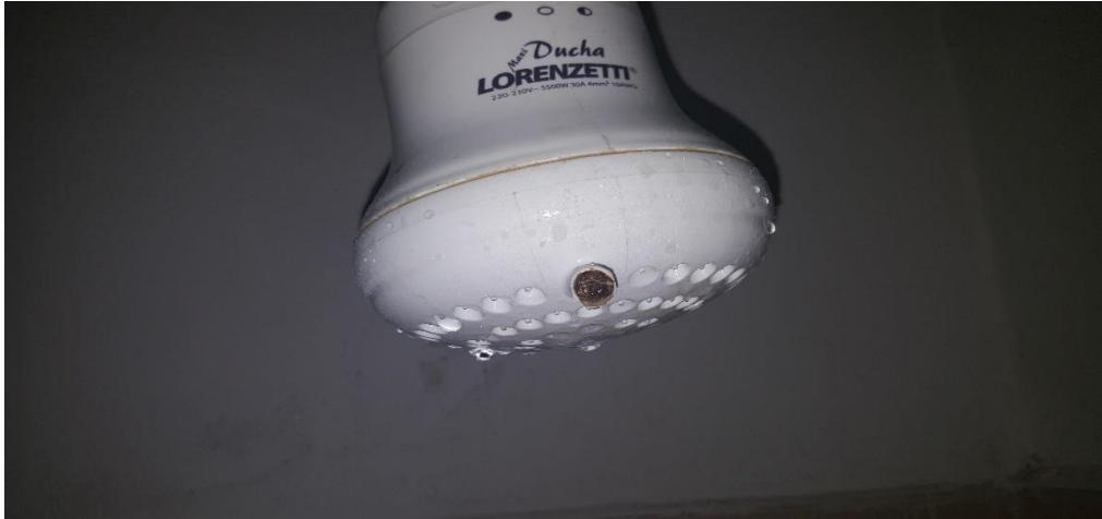
Ilustracion 7 duchas electricas
