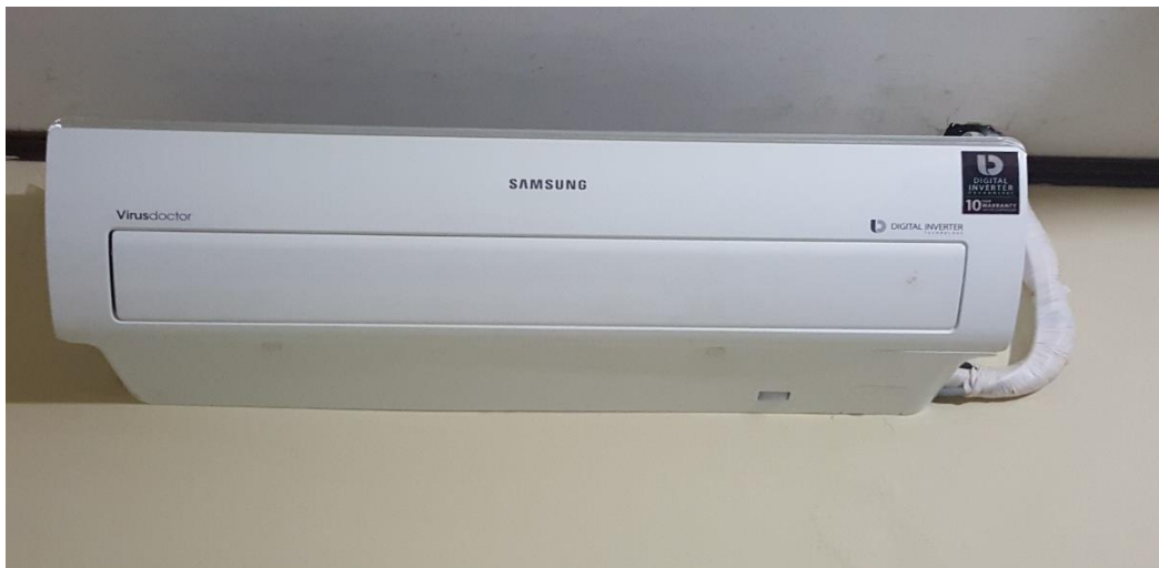
Ilustracion 9 AA inverter una de las 6 unidades que tiene el hotel
