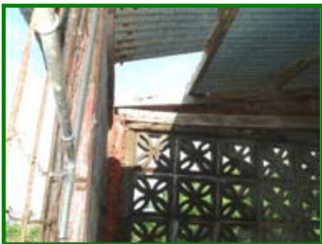
Nótese el deterioro de la cubierta.
