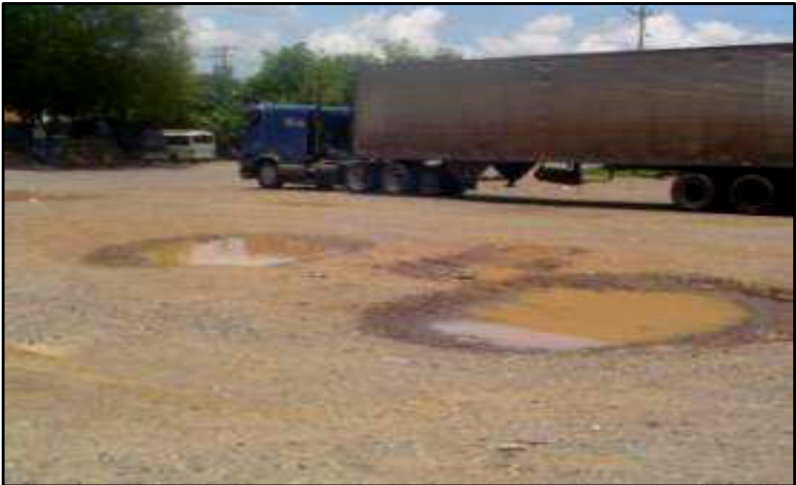
Estacionamiento en mal estado
