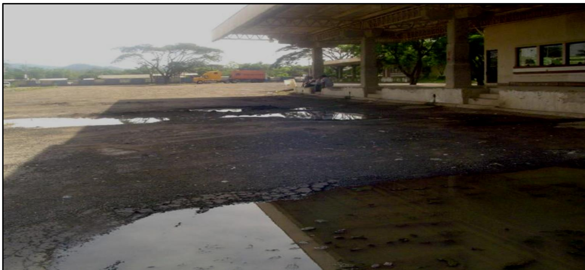
Área de Estacionamiento en mal estado.
