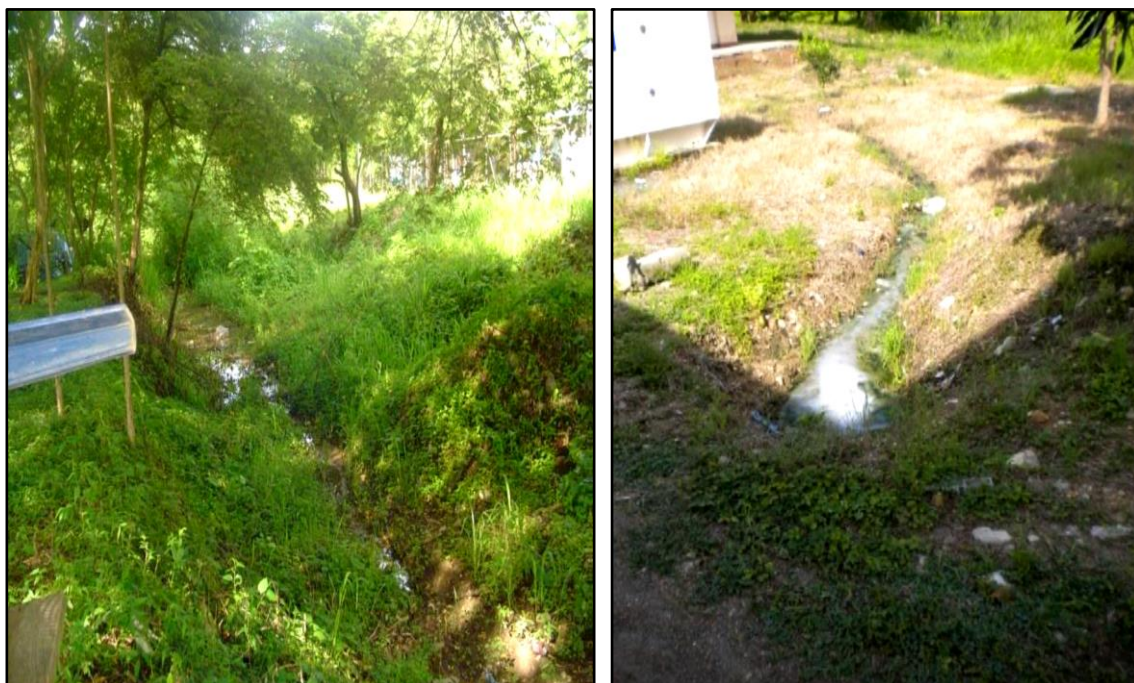
Cauce revestido obstaculizado por falta de limpieza
