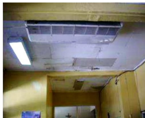
Cielo falso dañado, cableado superficial
