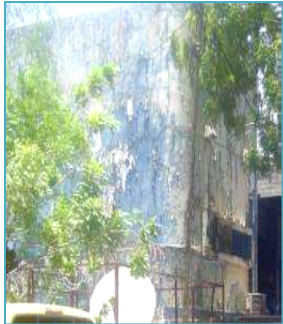
Descascaramiento en paredes.
