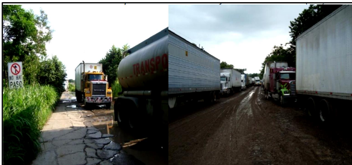
Figura 25 Áreas de pavimentos de lastre y concreto fallados (CR)
