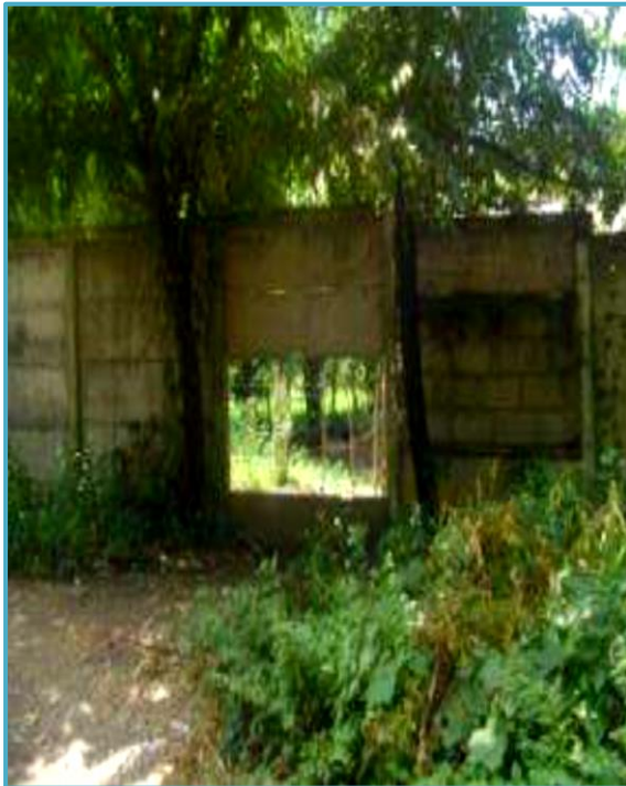
Boquete en muro colindante
