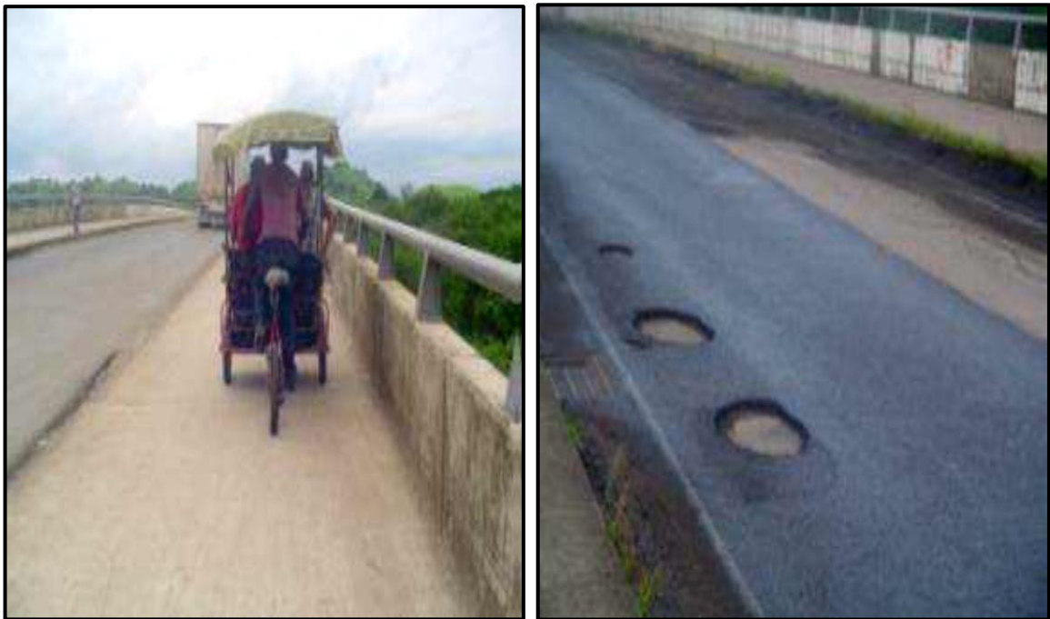
Figura 5 Estado de la carpeta de rodadura del puente sobre el Río Guasaule
