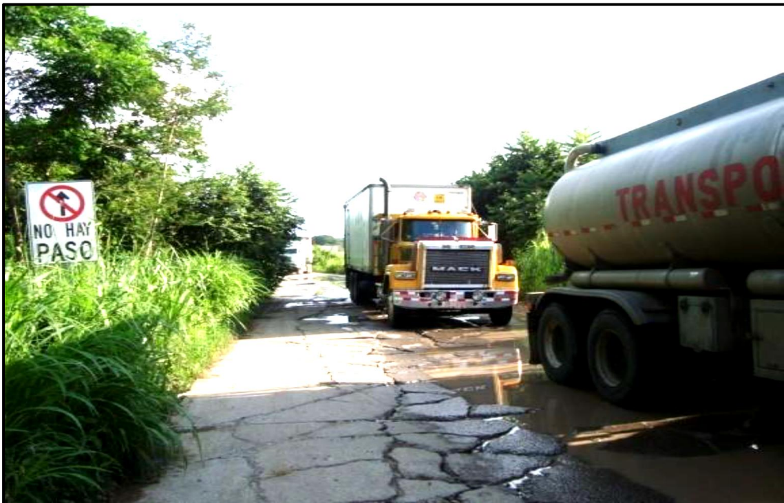
Áreas de pavimentos de lastre y concreto fallados (CR)
