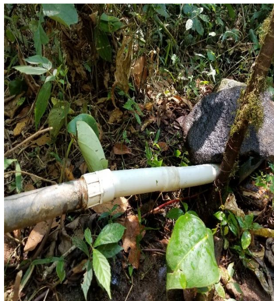
Imagen 1.16 Tubería en línea de conducción
