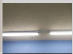
14 C DESPRENDIMIENTO DE ACABADO
