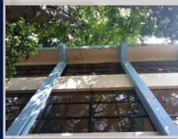
06 A HUMEDAD POR FILTRACION
