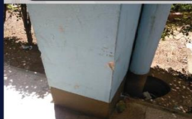
11 A DESPRENDIMIENTO DE ACABADO
