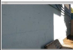
13 A FISURA, EROSION EN LABASE
