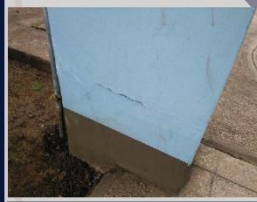
05 A EROSION EN LA BASE
