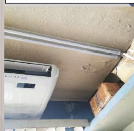
10 C DESPRENDIMIENTO DE ACABADO
