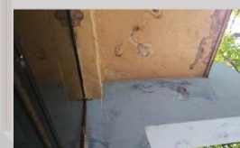
05 C FILTRACIÓN POR HUMEDAD, MOHO,
