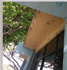
02 C FILTRACIÓN POR HUMEDAD, MOHO
