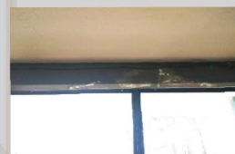
04 C DESPRENDIMIENTO DE MATERIAL
