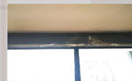
04 C DESPRENDIMIENTO DE MATERIAL
