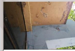
05 C FILTRACIÓN POR HUMEDAD, MOHO,
