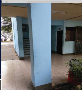
12 A EROSION EN LA BASE, DESPRN. MATERIAL
