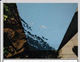
08 A DESPRENDIMIENTO DE MATERIAL
