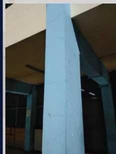
10 A DESPRENDIMIENTO DE
