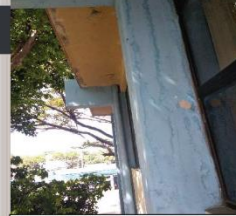
01 C ENSUCIAMIENTO POR LAVADO
