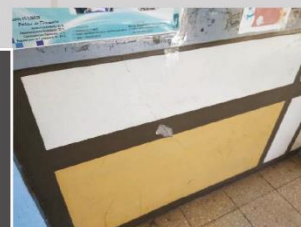
03 A - DESPRENDIMIENTO DE ACABADO
