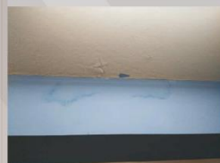
12 C FILTRACIÓN POR HUMEDAD, EFLORESCENCIA
