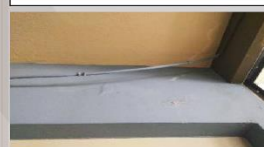
11 C EROSIÓN QUÍMICA
