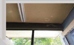
08 C FILTRACIÓN POR HUMEDAD, MOHO,
