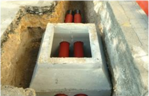
Sistema de cableado subterráneo
