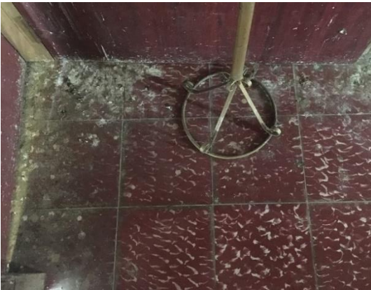
Imagen 58. Suciedad y erosión de material de piso causada por animales de porte. Fuente: Autores Propuesta de Conservación y Plan de Gestión de la Iglesia Santiago Apóstol de Telica, León, Nicaragua.
