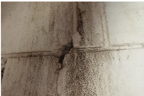
Imagen 53. Presencia de suciedad en muro frontal.
