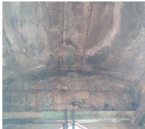
Imagen 57. Presencia de erosión química en cubierta de torre de campanario. Fuente: Autores Propuesta de Conservación y Plan de Gestión de la Iglesia Santiago Apóstol de Telica, León, Nicaragua.
