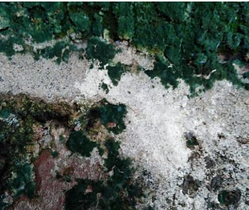
Imagen 56. Presencia de Eflorescencia en muro de la torre del campanario. Fuente: Autores Propuesta de Conservación y Plan de Gestión de la Iglesia Santiago Apóstol de Telica, León, Nicaragua.
