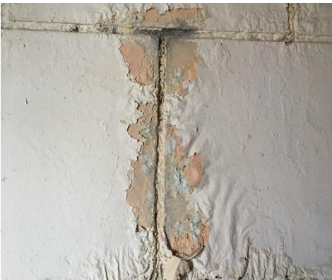
Imagen 51. Presencia de humedad por condensación en muro frontal.
