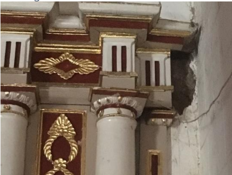
Imagen 55. Desprendimiento de material de recubrimiento en muro. Fuente: Autores Propuesta de Conservación y Plan de Gestión de la Iglesia Santiago Apóstol de Telica, León, Nicaragua.
