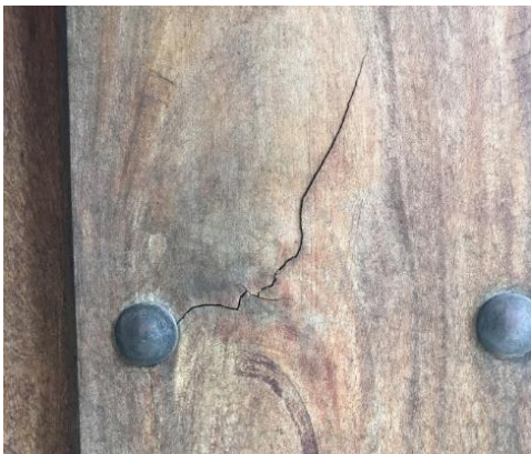
Imagen 54. Grieta por carga en puerta lateral. Fuente: Autores Propuesta de Conservación y Plan de Gestión de la Iglesia Santiago Apóstol de Telica, León, Nicaragua.
