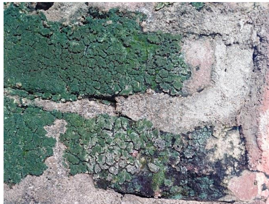
Imagen 59. Colonias de hongos ubicados en la torre de campanario. Fuente: Autores Propuesta de Conservación y Plan de Gestión de la Iglesia Santiago Apóstol de Telica, León, Nicaragua.
