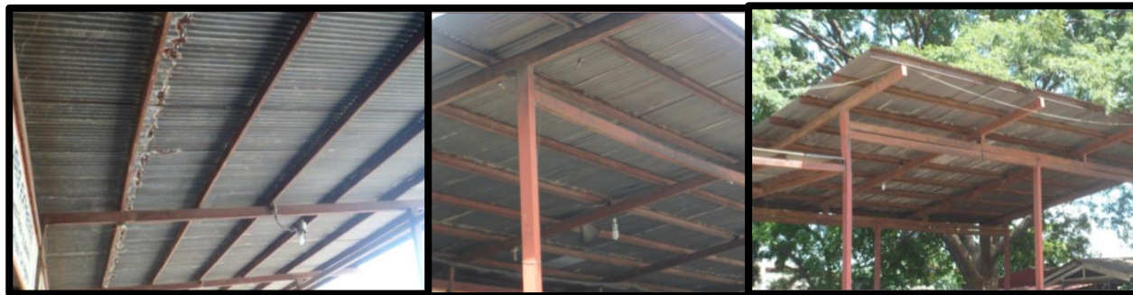
Ilustración 65. Oxidación de Cubierta de Techo, Oxidación en los elementos portantes de la Estructura del Techo en Área de Abordaje y Pandeo en Elementos Estructurales en el Área de Descenso. Fuente: Elaborado por Autoras 2020.
