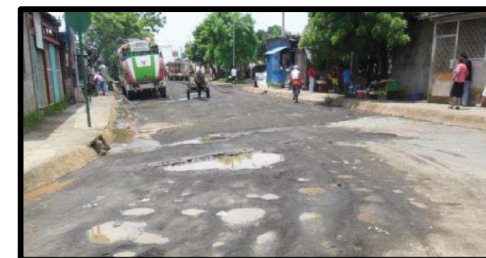
Ilustración 88. Primer Acceso Principal, Pista El Mayoreo, en Mal Estado.
