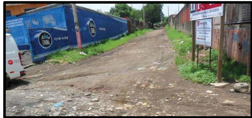
Ilustración 90. Primer Acceso Secundario, Pista El Mayoreo, Calles de Tierra en Mal Estado.
