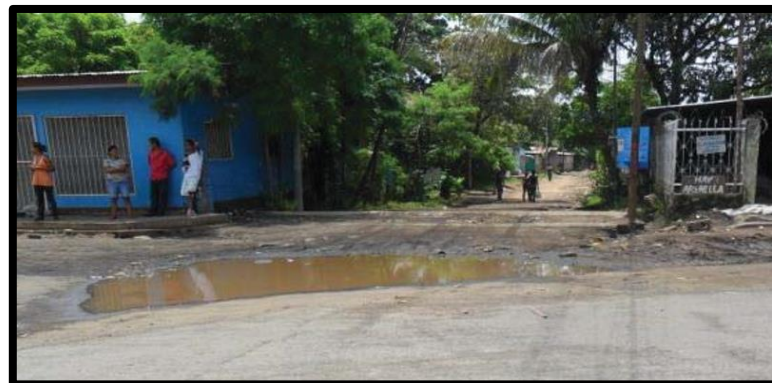
Ilustración 91. Segundo Acceso Secundario, Pista Sabana Grande, su Vía de Acceso también en Mal Estado.
