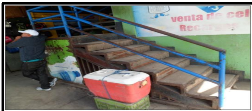
Ilustración 52. Escalera Improvisada en el Área de Circulación de la Terminal Rigoberto Cabezas.
