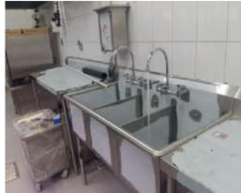
Imagen 111 Sistema de agua en áreas de procesos en funcionamiento Fuente propia.
