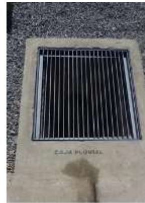
Imagen 73 Registros del sistema pluvial con rejillas y señalización
