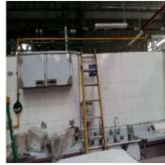
Imagen 116 Válvula de gas en área de proceso Fuente propia.
