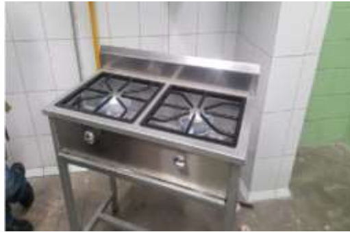
Imagen 115 Tubería de gas en soda Fuente propia.
