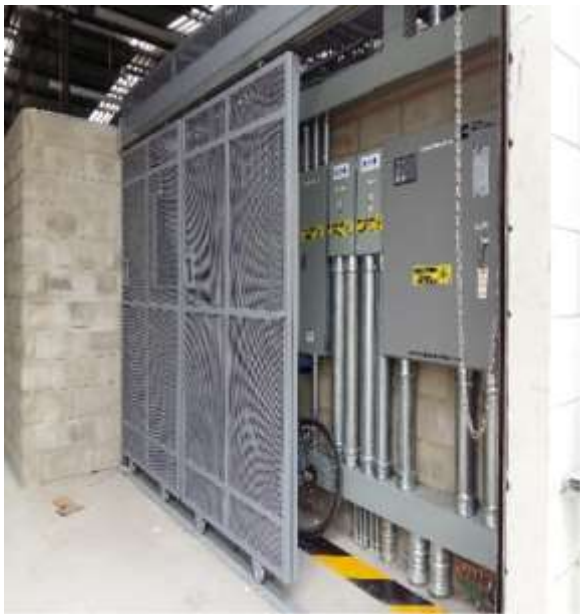
Imagen 108 Cuarto eléctrico finalizado. Fuente propia.
