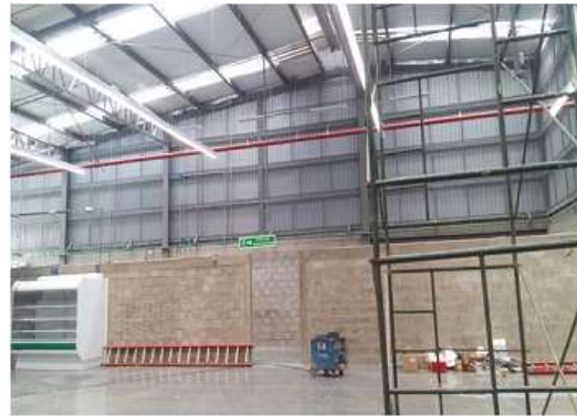
Imagen 107 Instalación de Gabinetes de red interna de SCI. Fuente propia. Fuente propia.
