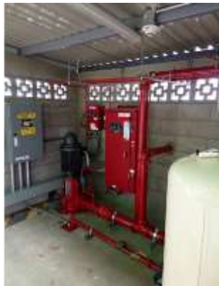
Imagen 72 Equipo de bombeo SCI instalado. Fuente: Elaboración propia.
