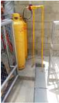
Imagen 114 Encierro de gas y trinchera Fuente propia.
