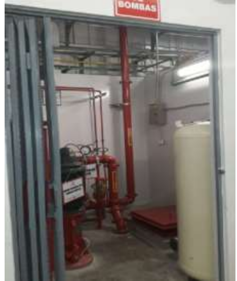
Imagen 132 Cuarto de bombas y cisterna .
