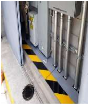
Imagen 71 Señalización de cuartos de paneles/Fuente propia
