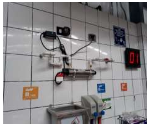
Imagen 75 Previstas del sistema potable en carnicería
