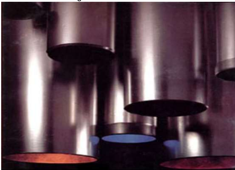
Imagen # 14: Tuberías metálicas
