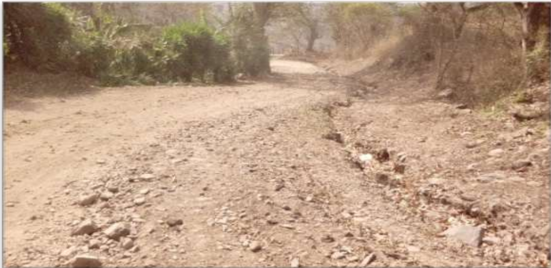
Imagen No. 39: Muestra presencia de cárcava producido por las corrientes de aguas, Estación 122+650 a 122+772.10
