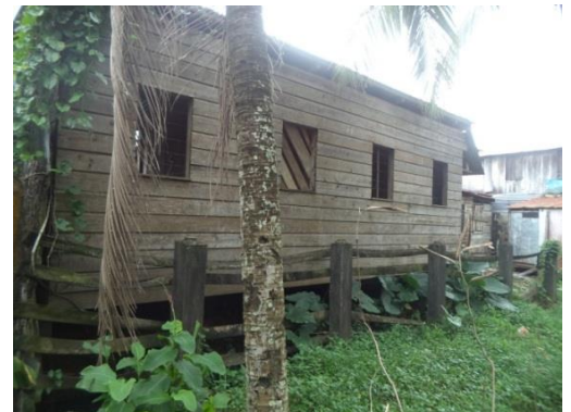
Fotografía No.2: Condiciones de la casa de madera sobre pilotes. Fuente: Captura
