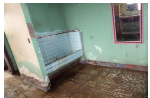
Fotografía No.3: Insalubridad en servicios sanitarios.
