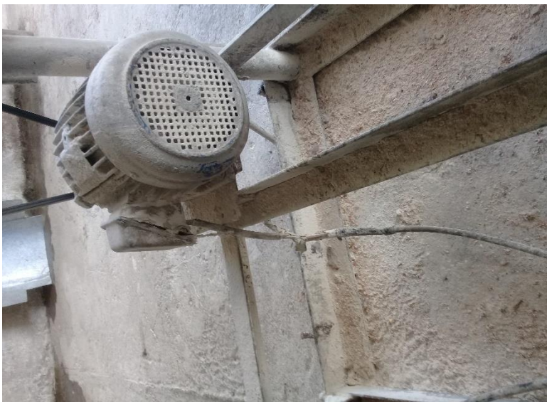
Motor 3 Hp en área de descarga, falta de mantenimiento.
