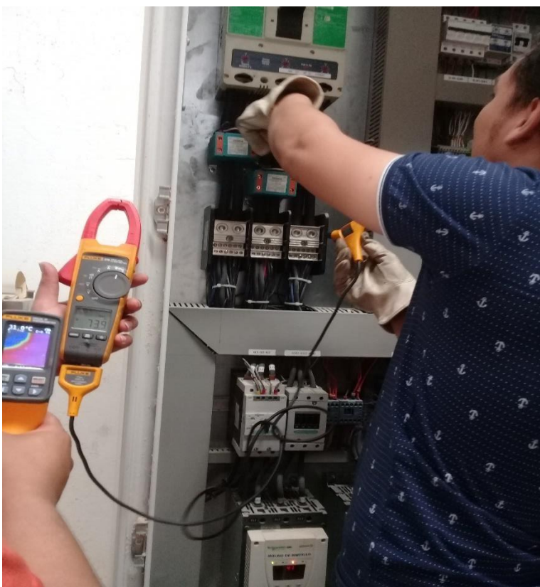
Mediciones puntuales en sub paneles.
