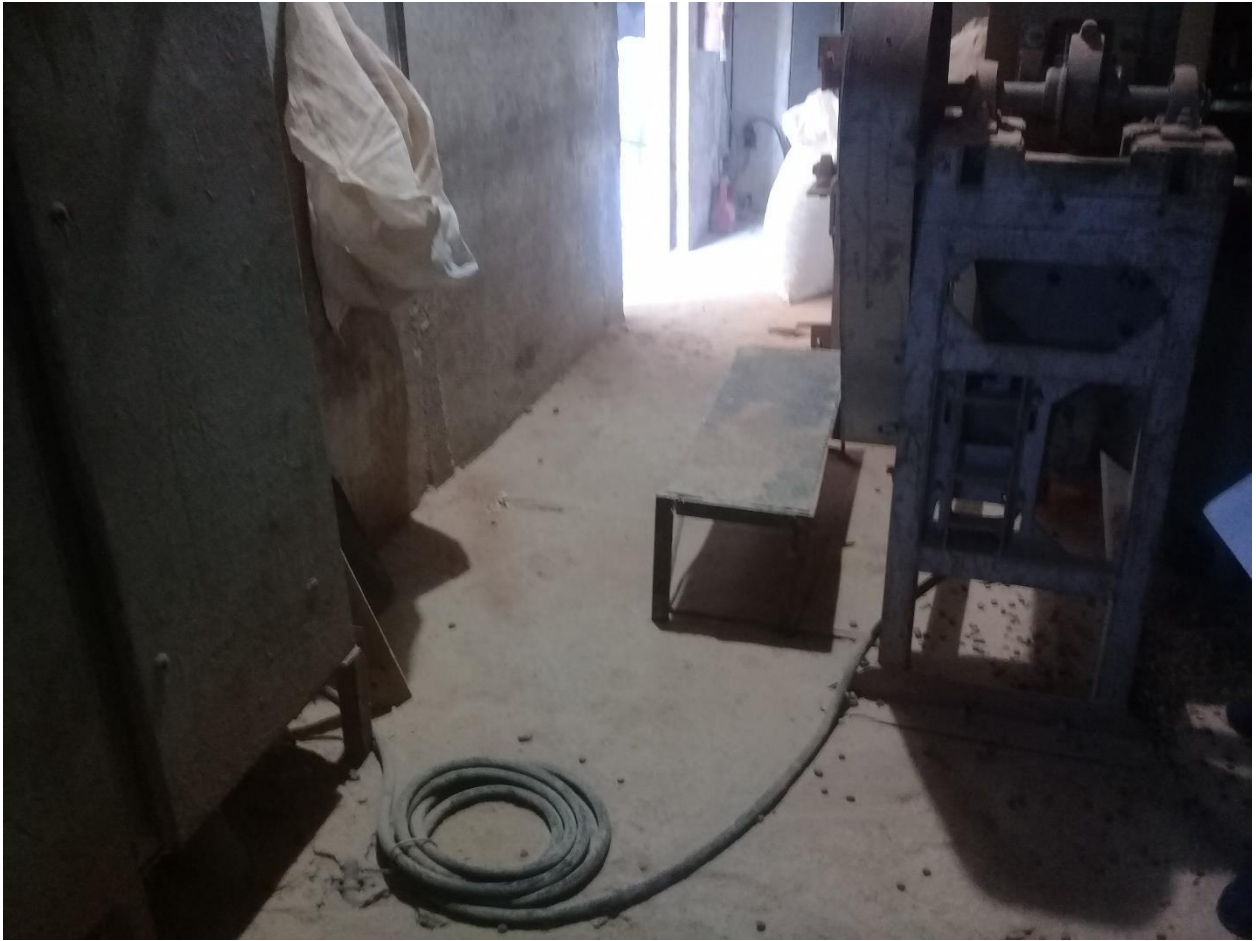
Cable de alimentación a motor de 100 HP sobre el área de trabajo.
