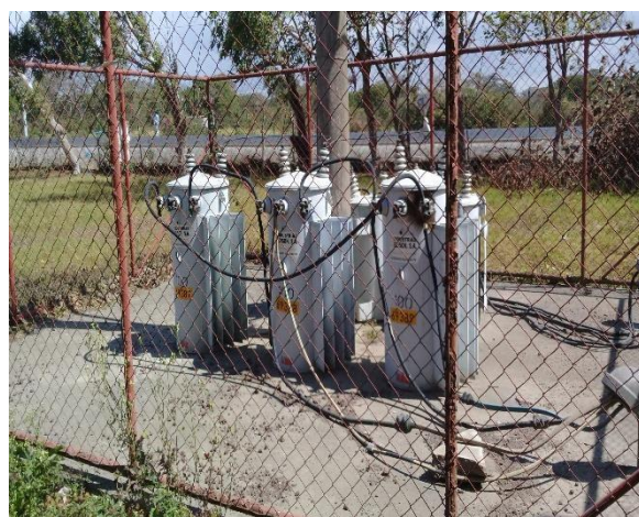
Ilustración 14. Banco de transformadores 3x 775 kVA y 3 x 100 kVA.
