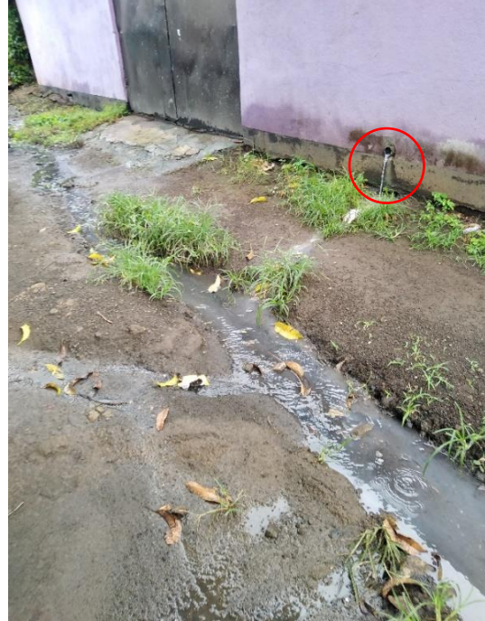
Nota. Nótese el desagüe de las aguas residuales.
