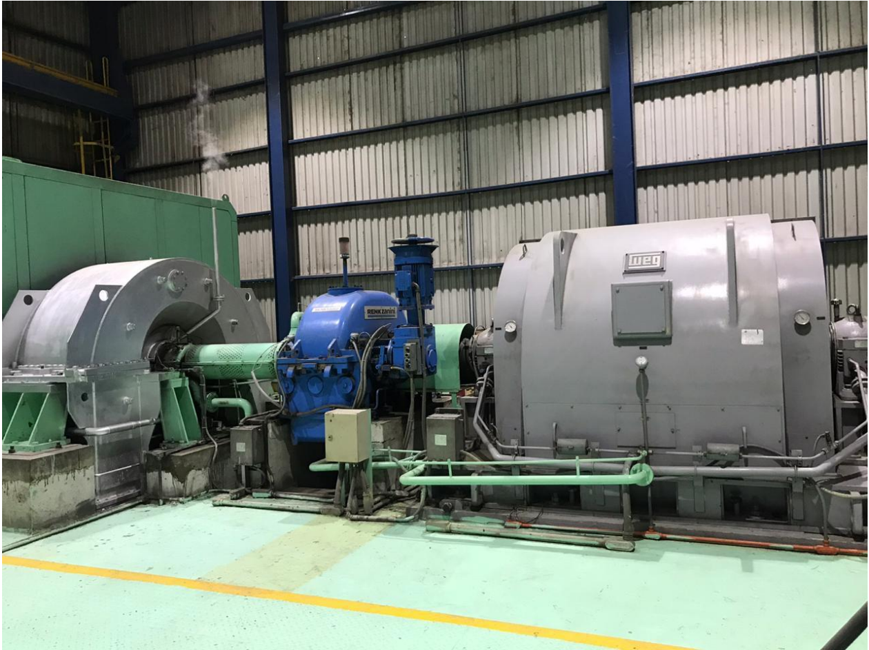
Anexo 1.4, Turbogenerador de condensación de 16.4MW en la Planta Eléctrica Monte Rosa.
