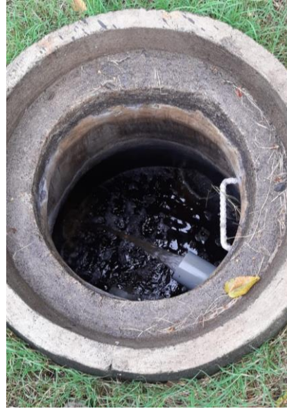
Figura 5.5: Salida del agua residual en el humedal
