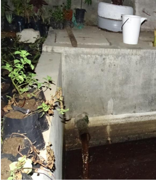
Figura 5.4: ingreso del agua residual al humedal
