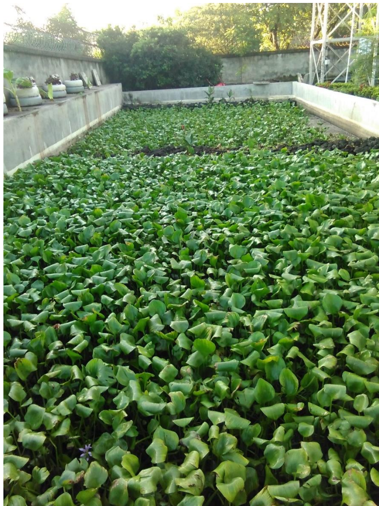
Figura K-15: Humedal Artificial de flujo horizontal en el rastro municipal de León
