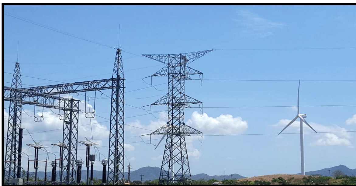
Fig.8 Subestación San Juan del Sur
