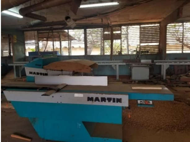
Anexo 5. Máquina Graule pegada a la ventana, máquina, Cepilladora en el centro máquina encuadradora en el frente.
