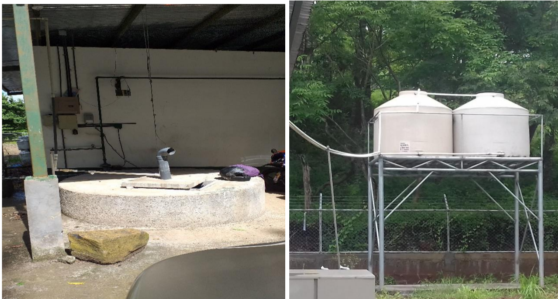
Ilustración 20: Abastecimiento de agua en la empresa
