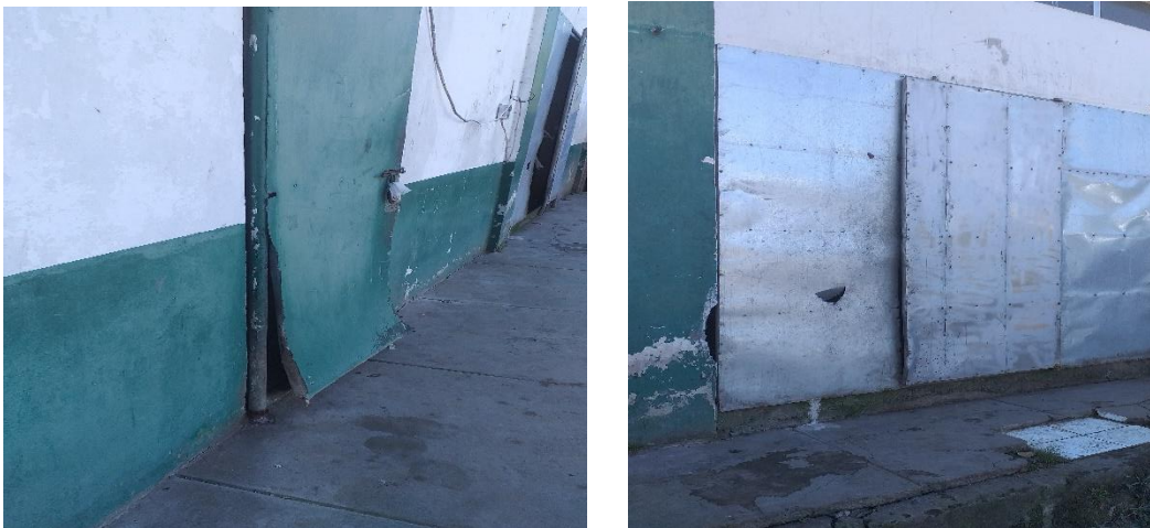
Ilustración 9: Puertas de entrada en mal estado.
