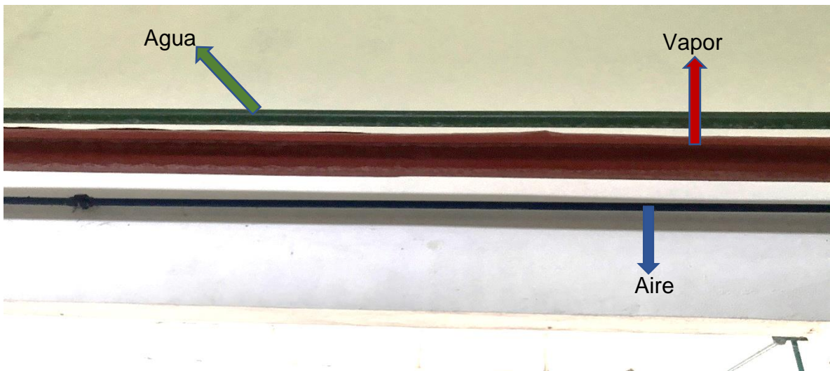
Ilustración 22: Identificación de tuberías
